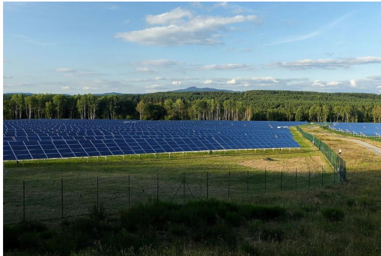
Obr. 2-2 Fotovoltaická elektrárna Ralsko Ra 1 [42]
