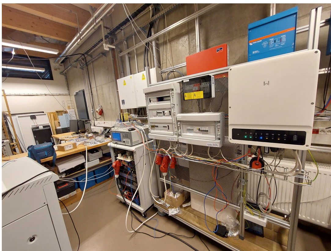
Obrázek 5.1. Měřicí pracoviště v budově ČVUT UCEEB.
