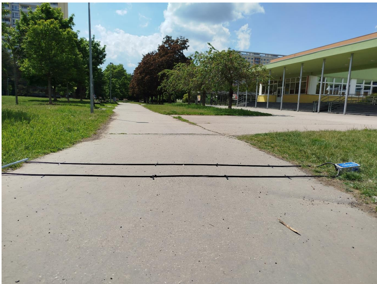
Obr. 20 Pneumatický detektor instalovaný na stezce [zdroj vlastní]
