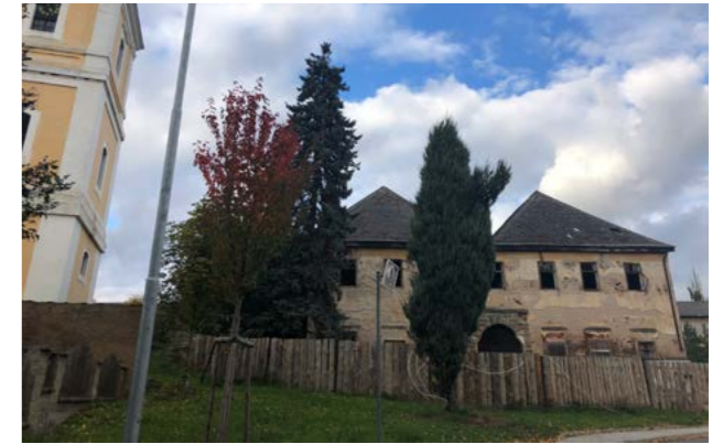
Obr. 79: Chátrající budova žihelského zámku sousedící s kostelem sv. Václava (foto autorka 29.9.2023)
