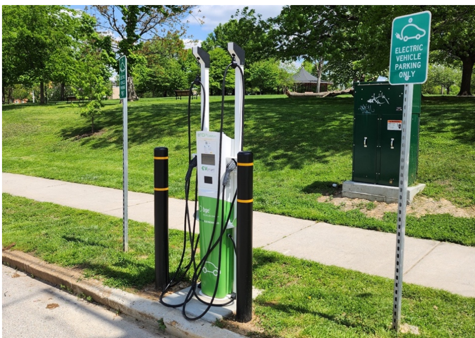
OBRÁZEK 2 RYCHLONABÍJECÍ AC STANICE V PARKU (CITY OF BALTIMORE, 2023)
