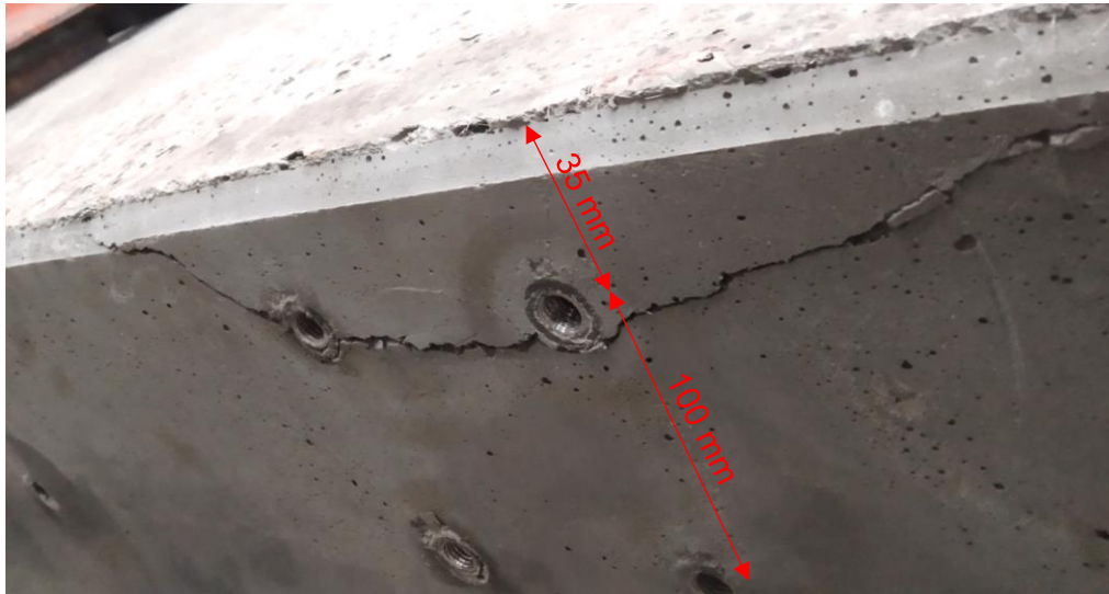
Obr. 107 Porušení kotevní oblasti I-X nosníku
