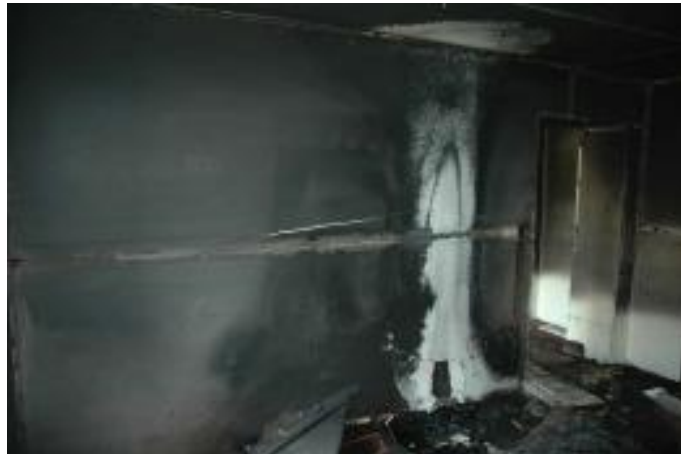
Obrázek 9 Konstrukce po požáru - viditelné účinky požáru [16]
