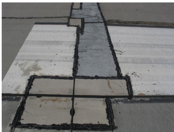
Obrázek 26: Nevhodná oprava ulomených rohů
