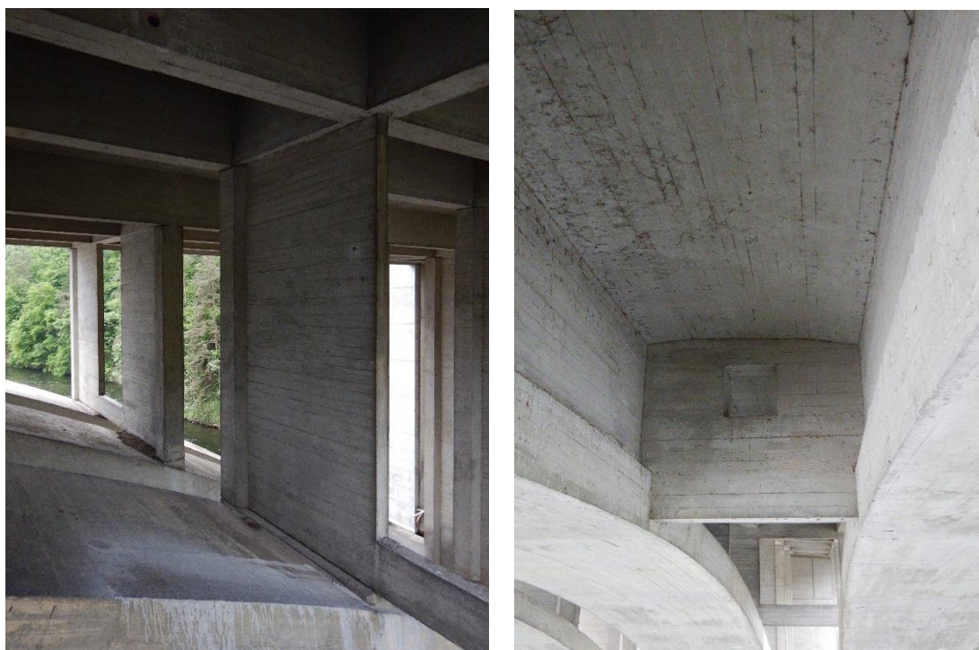
Obrázek 7 Pohled na kyvné stojky oblouku a obloukové pasy – diagnostika
