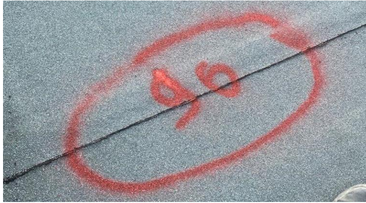
Obr. č. [50] Vyznačení místa se zvýšenou mírou vlhkosti „2“ (vlastní fotodokumentace)
