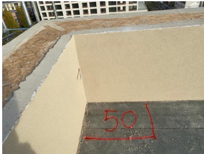
Obr. č. [41] Nalezena zvýšená míra vlhkosti pod hydroizolační vrstvou v rizikovém místě „2“ (vlastní fotodokumentace)
