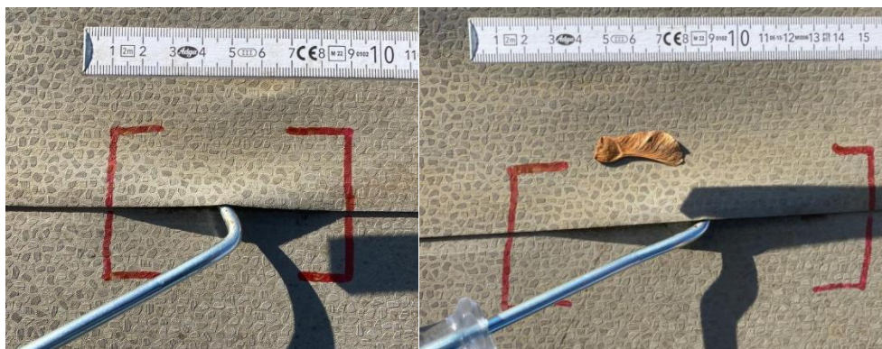
Obr. č. [24] Vady zapříčiněné nesprávným svarem pásů hydroizolace bez naměřené zvýšené míry vlhkosti (vlastní fotodokumentace)
