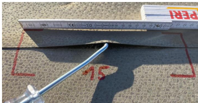
Obr. č. [23] Defekt s detekovanou zvýšenou mírou vlhkosti (vlastní fotodokumentace)
