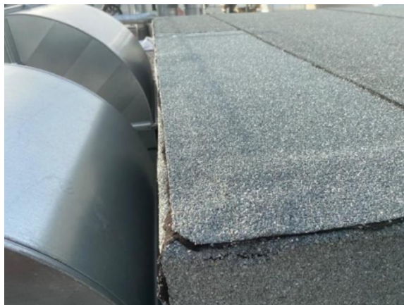
Obr. č. [45] Obecné rizikové místo styku vodorovné a svislé vrstvy hydroizolačního povlaku „2“ (vlastní fotodokumentace)
