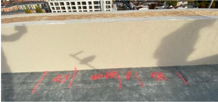
Obr. č. [43] Nalezena zvýšená míra vlhkosti pod hydroizolační vrstvou v rizikovém místě „4“ (vlastní fotodokumentace)
