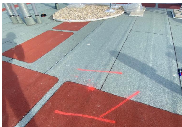
Obr. č. [52] Vyznačení místa se zvýšenou mírou vlhkosti „4“ (vlastní fotodokumentace)
