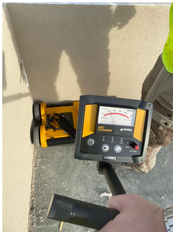
Obr. č. [40] Nalezena zvýšená míra vlhkosti pod hydroizolační vrstvou v rizikovém místě „1“ (vlastní fotodokumentace)
