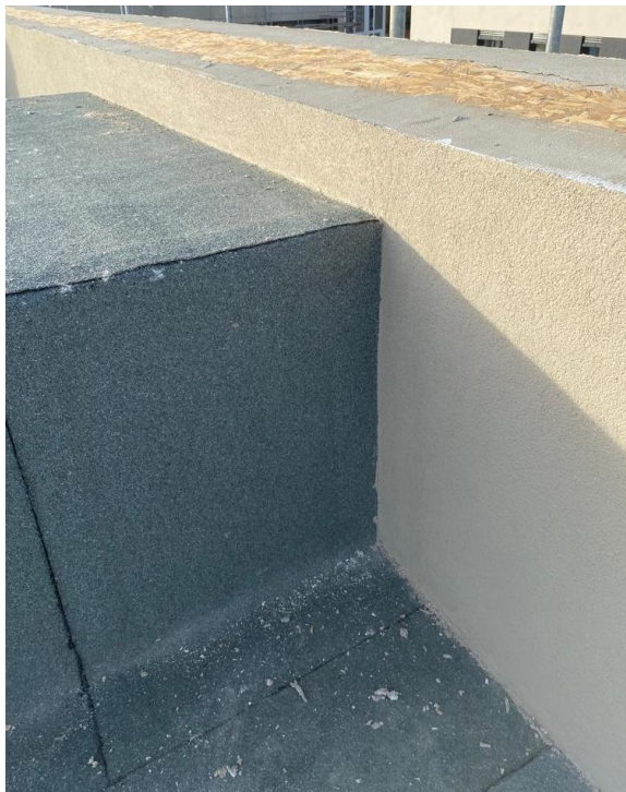
Obr. č. [44] Obecné rizikové místo styku vodorovné a svislé vrstvy hydroizolačního povlaku „1“ (vlastní fotodokumentace)
