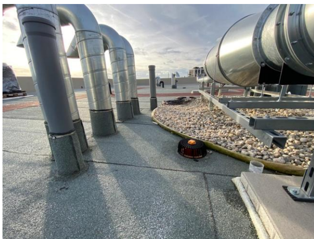
Obr. č. [10] Z obrázku je patrný zvýšený povrch povlakové hydroizolace v okolí prostupů malého průřezu
