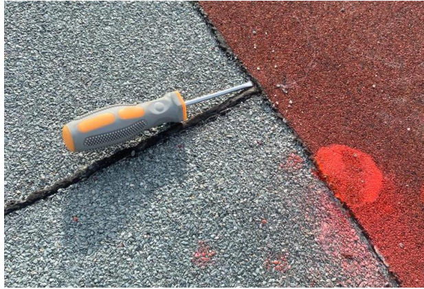
Obr. č. [48] Ohledání místa s výskytem větší míry vlhkosti, zkouška těsnosti spojů asfaltových pásů – defekt nebyl nalezen (vlastní fotodokumentace)
