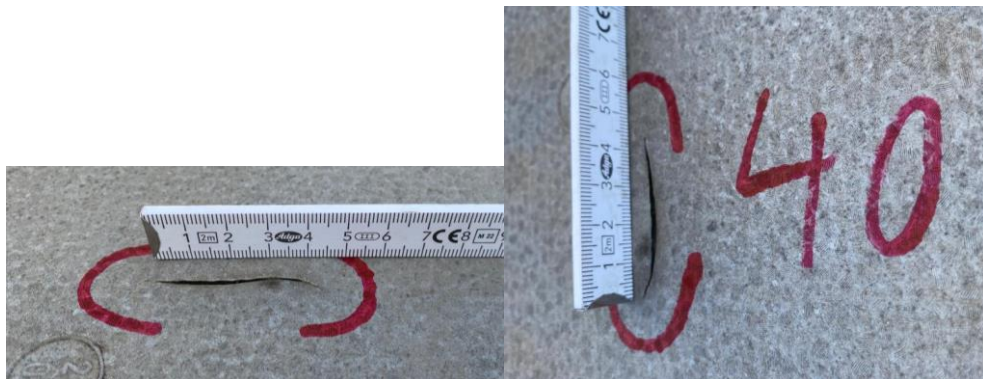
Obr. č. [26] Defekt způsobený proříznutím s detekovanou vlhkostí (vlastní fotodokumentace)
