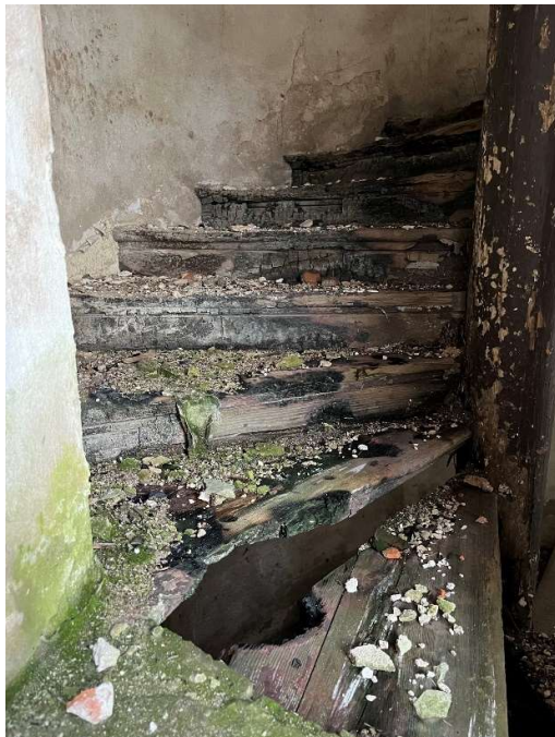
Obrázek 122 - Ohořelé schodišťové stupně, včetně výskytu mečů – pohled z okenního otvoru v 1.NP
