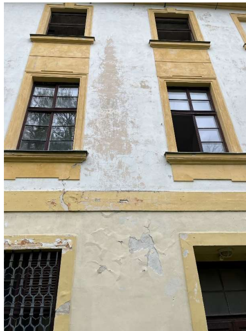
Obrázek 127 - Zvlněná omítka a povrchově porušená omítka na západní fasádě objektu
