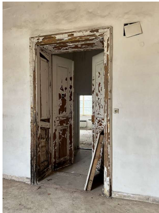
Obrázek 143 - Odlupující se nátěr na všech dřevěných prvcích výplně otvoru, destrukce části deštění
