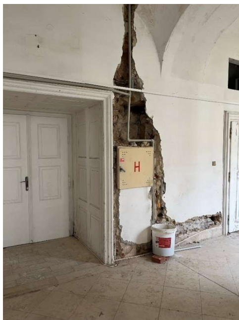
Obrázek 48 - Pohled na stávající hydrantovou skříň v chodbě 0.02
