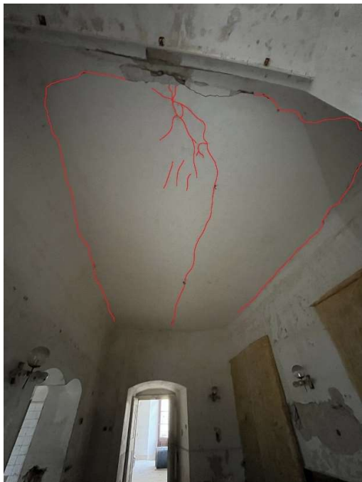
Obrázek 101 - Trhliny v omítce na stropě v místnosti č. 0.47 v jižní části
