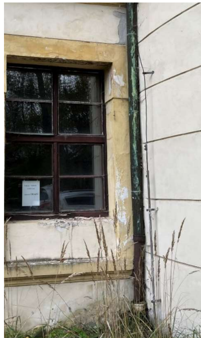
Obrázek 158 - Elektrolytická koroze části dešťového svodu
