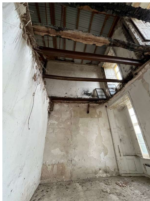
Obrázek 106 - Pohled na ocelové a dřevěné ohořelé nosníky v místnosti č. 1.10c
