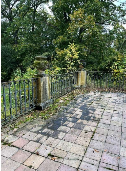
Obrázek 159 - Dlažba pokrytá plísněmi a mechy, vyšší rostliny, degradace omítky na pilířích zábradlí
