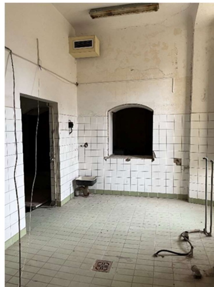
Obrázek 51 - Potrubní výustka jižní křídlo
