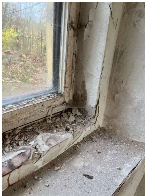
Obrázek 136 - Detailní pohled na rozrušenou omítku v oblasti parapetu
