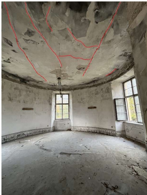
Obrázek 113 - Požární vodou vypláchnuté nečistoty usazené v konstrukci stropu, trhliny v omítce - místnost č. 1.22
