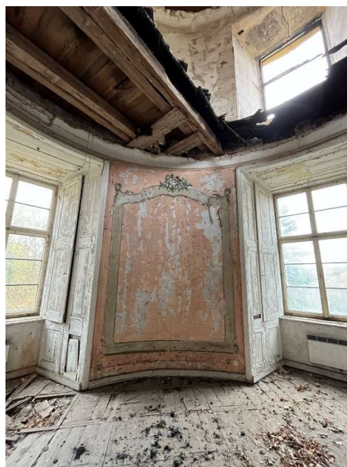
Obrázek 153 - Degradovaná nášlapná vrstva v místnosti č. 1.12
