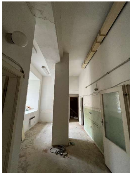
Obrázek 50 - Vzduchotechnické potrubí ve východním křídle
