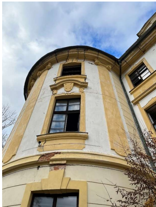
Obrázek 92 - Pohled na stávající sepnutí a stehování trhlín JZ rondelu, narušení omítky klenáku a římsy
