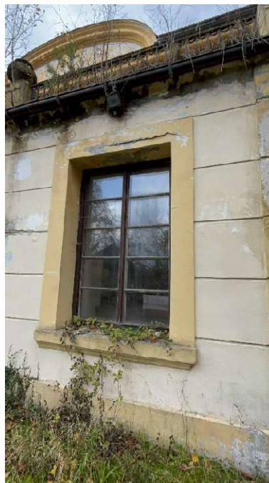
Obrázek 134 Pohled na severní část přístavku, výskyt vyšších a popínavých rostlin oblasti soklu, parapetu a okapu
