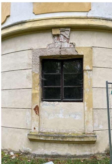
Obrázek 66 - Okno SZ rondelu, částečně zazděno, parapet bez oplechování, bez spádování
