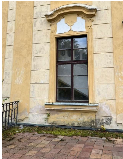
Obrázek 162 - Pohled na soklovou a podparapetní část, dlažba pokryta mechy, stěny plísněmi
