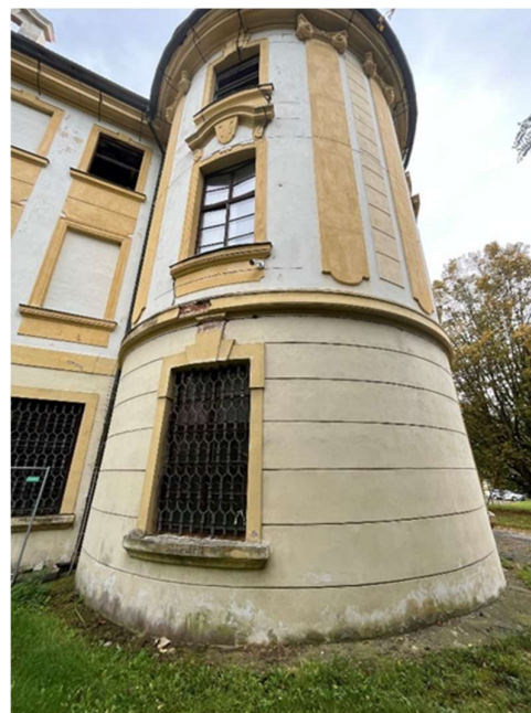
Obrázek 55 - Pohled na stávající sanační opatření – trhliny na JZ věžici
