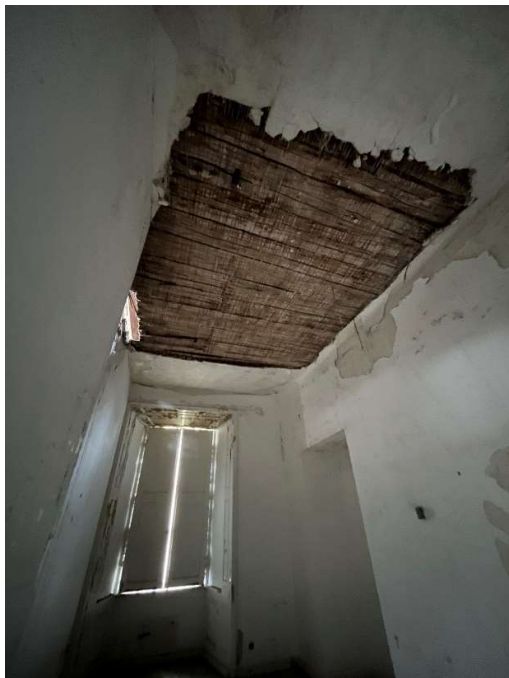
Obrázek 103 - Průhyb a lokální absence rákosové omítky v místnosti č. 1.07d
