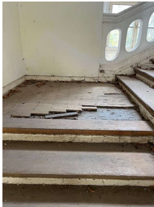
Obrázek 121 - Chybějící a poničená nášlapná vrstva mezipodesty
