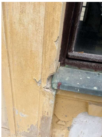
Obrázek 139 - Detailní pohled na osazení vnějšího parapetu v ostění, odlupování omítky v okolí
