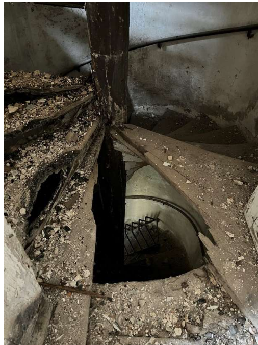
Obrázek 123 - Ohořelé a chybějící schodišťové stupně – pohled ze vstupu na schodiště v 1.NP
