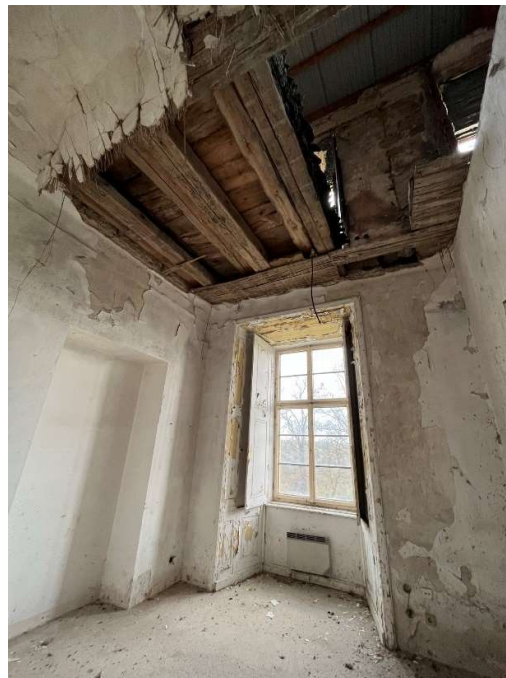
Obrázek 104 - Pohled na požárem poničený dřevěný trámový strop v místnosti č. 1.07b
