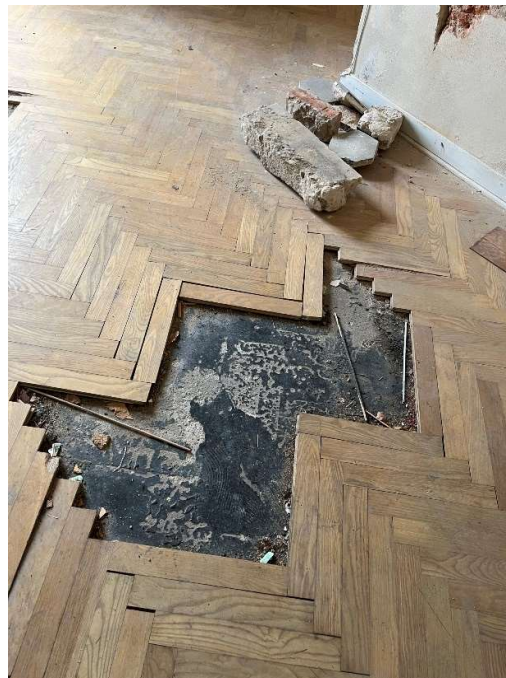
Obrázek 151 - Chybějící část nášlapné vrstvy z dřevěných parket v místnosti č. 0.07
