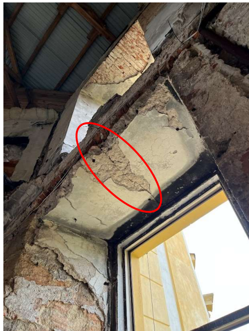
Obrázek 110 - Trhlina v nadpraží okna v místnosti č. 1.11
