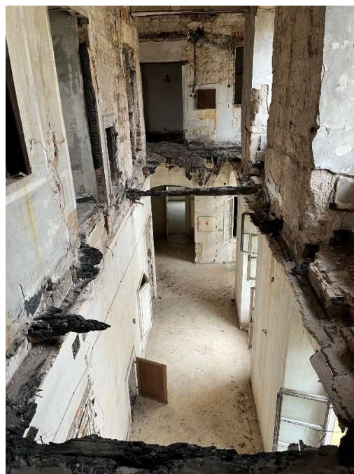
Obrázek 116 - Chybějící stropní konstrukce nad chodbou vlivem požáru v jižní části směr západ, pohled z 2.NP
