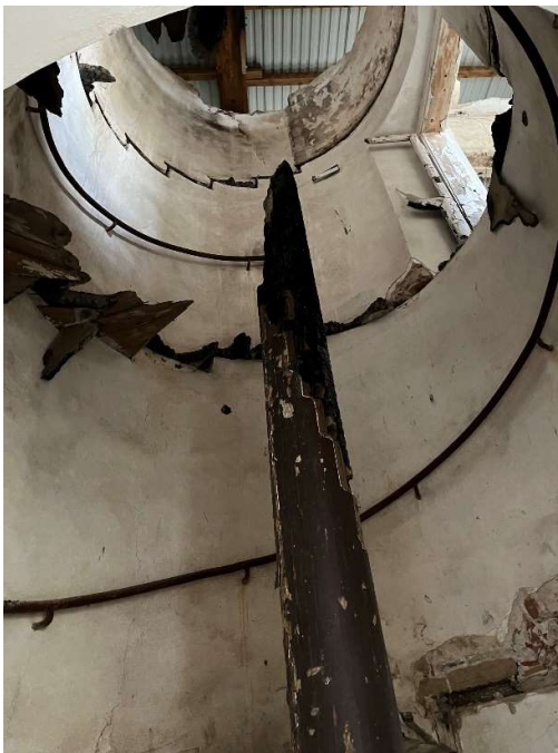
Obrázek 124 - Pohled směrem nahoru na středový sloup, chybějící schodišťové stupně v 1.-2.NP
