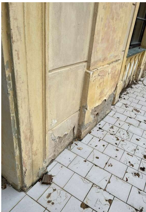
Obrázek 163 - Rozrušená a opadaná omítková vrstva v soklové oblasti balkonu, prohlubně v keramické dlažbě
