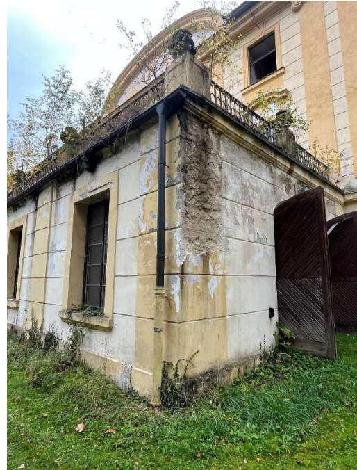
Obrázek 160 - Degradace fasádní omítky, vyšší rostliny a mechy na hraně terasy a v konstrukci okapu
