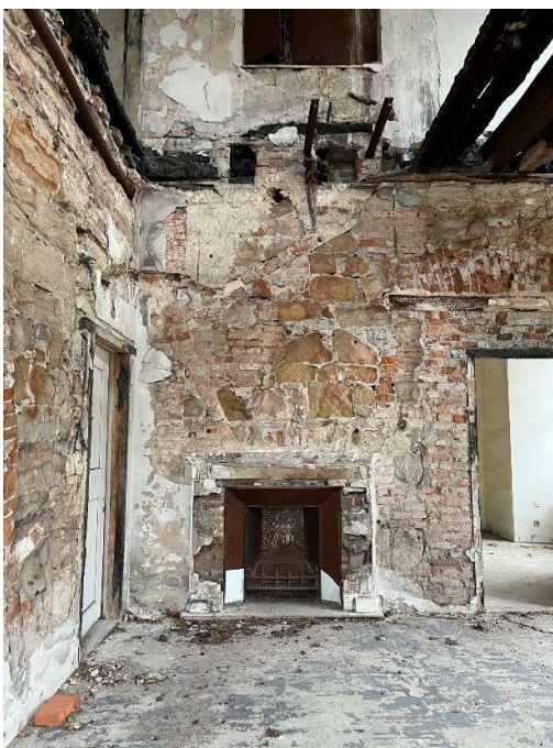
Obrázek 13 - Pohled na odhalené smíšené zdivo v 1.NP
