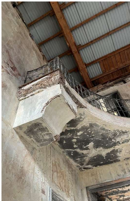
Obrázek 164 Pohled na konstrukci balkonu, opadaná a ohořelá omítka
