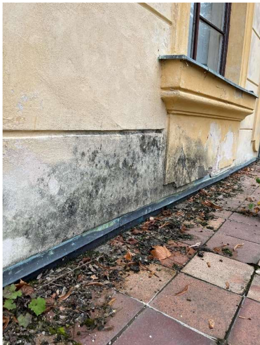
Obrázek 161 - Detailní pohled na výskyt plísní v soklové části terasy
