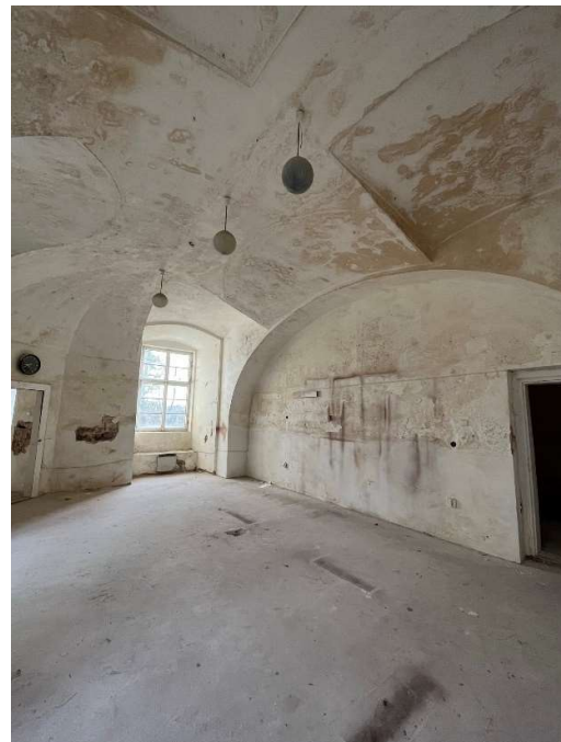
Obrázek 102 - Místnost č. 0.15, vlhkost a výskyt výkvětovorných soli
