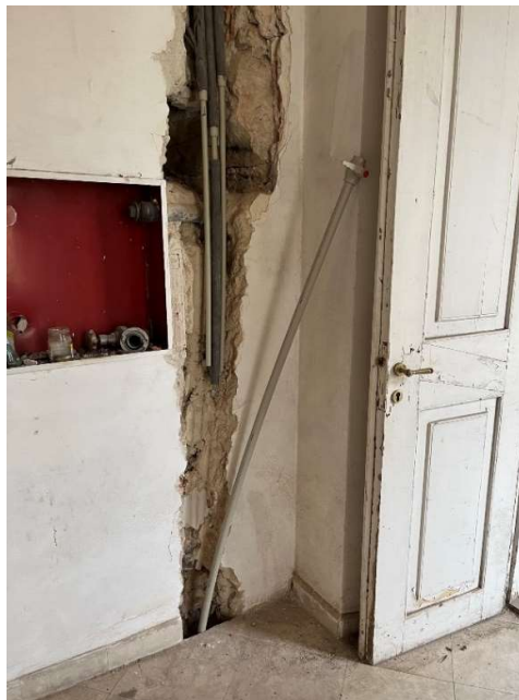
Obrázek 125 - Chybějící vystrojení hydrantové skříně, přerézané vodovodní potrubí
