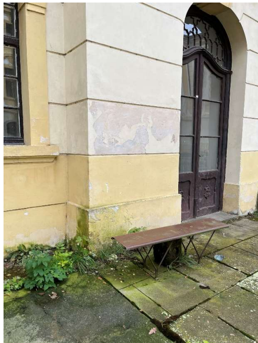
Obrázek 130 - Opadaná omítka a výskyt mechů/plísní na dvorní fasádě jižního křídla
