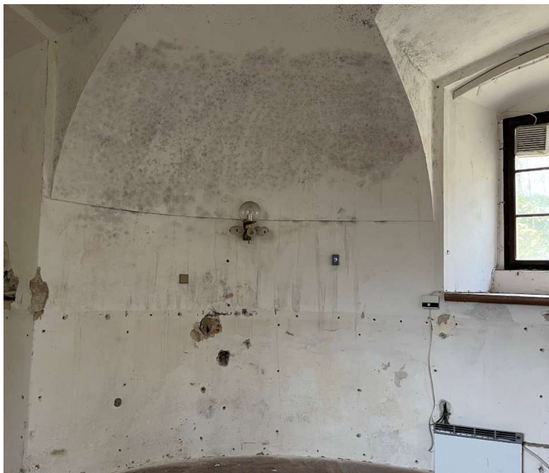
Obrázek 98 - Stěna v přízemí SZ rondelu, výskyt plísní
