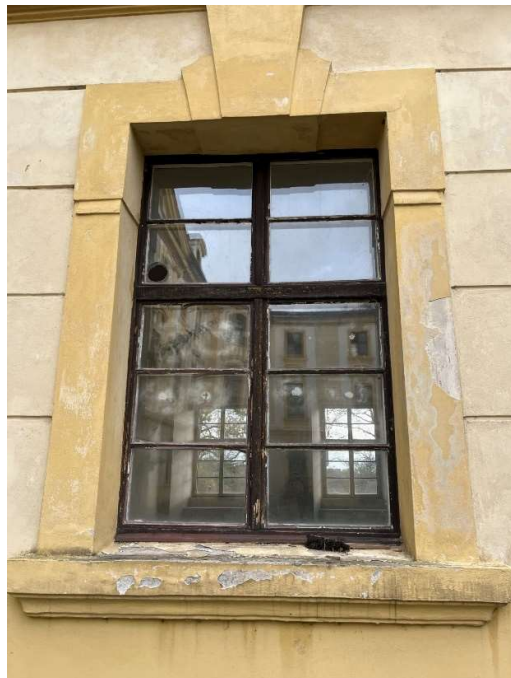
Obrázek 140 – Odlupující se nátěr dřevěného rámu, vlhkostní mapy a usazování plísní a nečistot na vnějším parapetu
