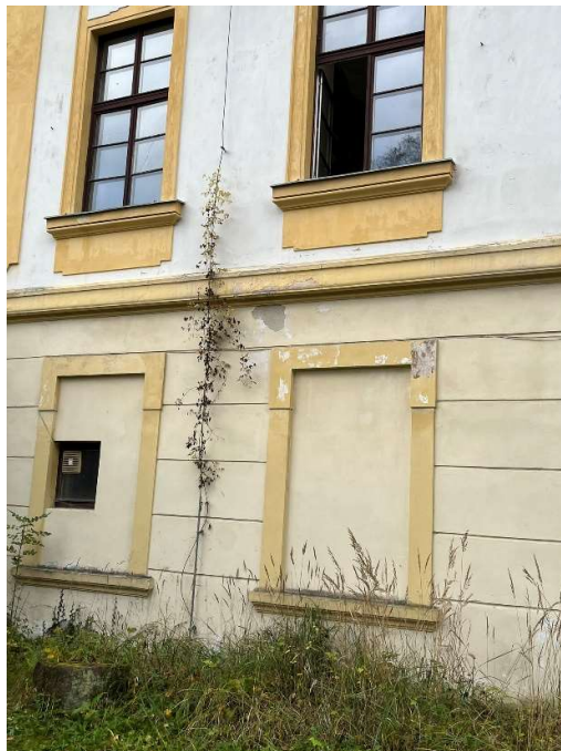
Obrázek 133 Výskyt vyšších rostlin v soklové oblasti severní fasády
