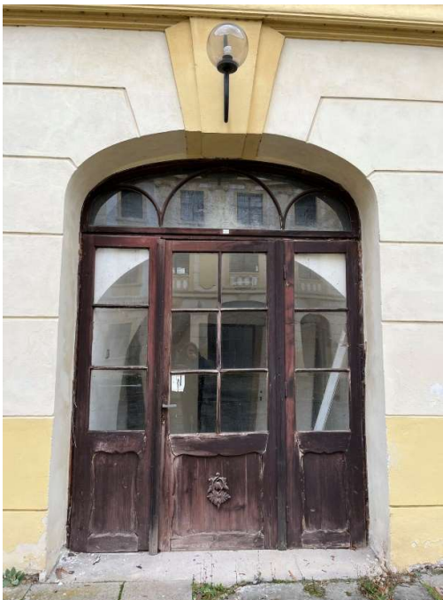
Obrázek 146 - Odlupující se nátěr na venkovních dveřích, ztenčená vrstva nátěru vlivem působení účinků slunečního záření a deště
