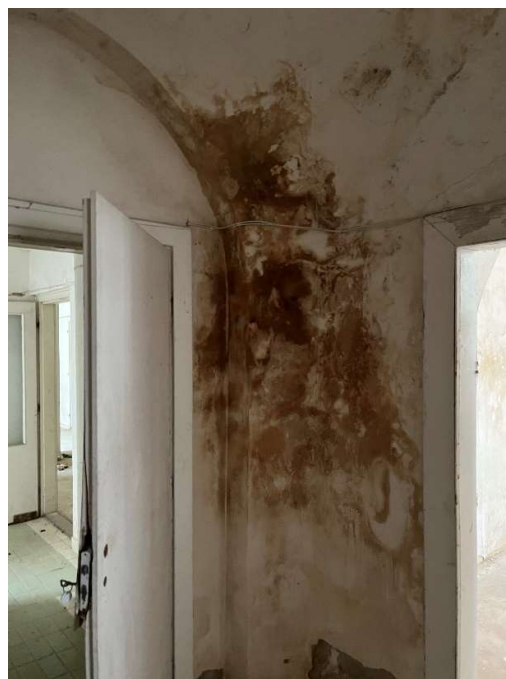
Obrázek 95 - Vlhkostní mapy s výskytem vyluhovaných solí v přízemí ve východní části objektu
