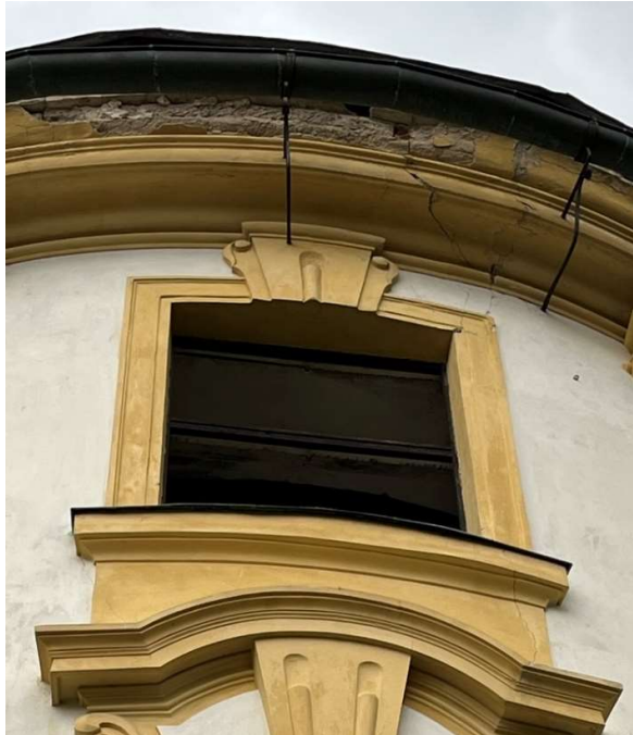
Obrázek 170 - Opadaná omítka a výskyt trhlin v korunní římsě
