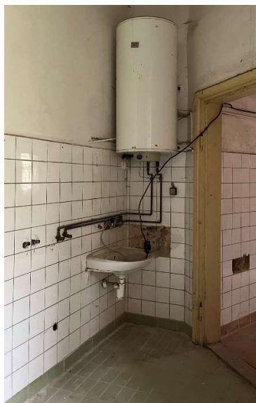
Obrázek 45 - Zásobník teplé vody, místnost č. 0.44
