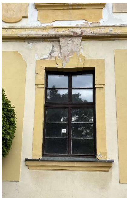
Obrázek 64 - Okno na jižní fasádě s ohraničující šambránou, parapet s oplechováním ve spádu
