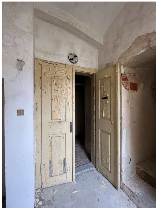
Obrázek 142 - Odlupující se nátěr na křídlech dveří
