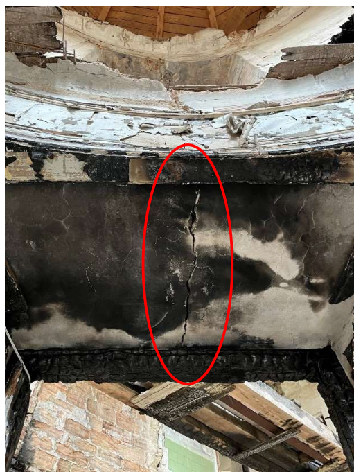
Obrázek 108 - Trhlina v nadpraží dveří mezi místnostmi č. 1.11 a 1.12 (SV rondel)
