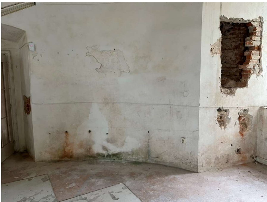
Obrázek 91 - Stěna SV rondelu, vlhkost, výskyt plísní, vybouraný otvor, odhalené zdivo
