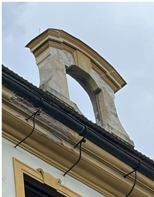
Obrázek 156 - Vlhkostní mapy a poškozená fasádní omítka na zděné konstrukci vikýře
