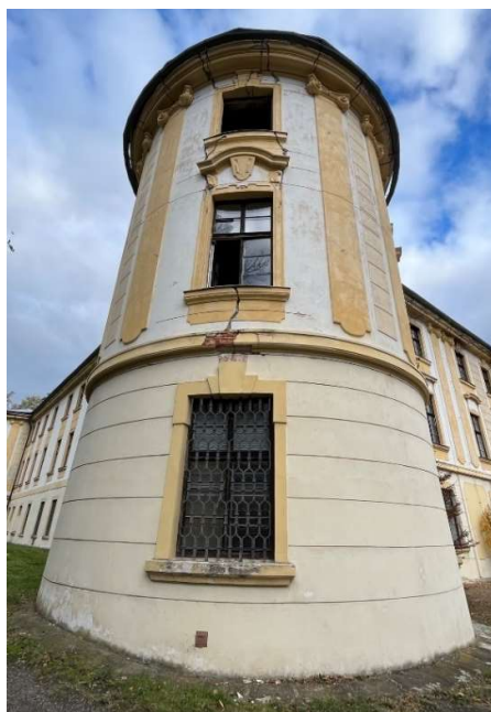
Obrázek 54 - Pohled na stávající sanační opatření – trhliny na JZ věžici
