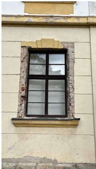
Obrázek 126 - Destrukce šambrány, zvlněné oplechování vnějšího parapetu
