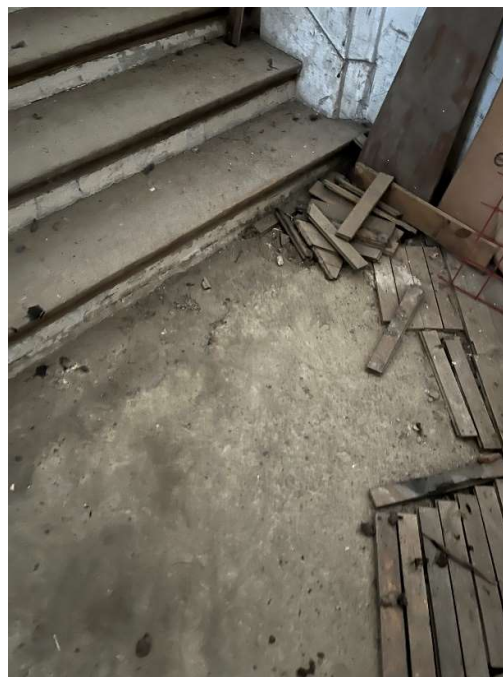
Obrázek 119 - Chybějící a poničená nášlapná vrstva mezipodesty
