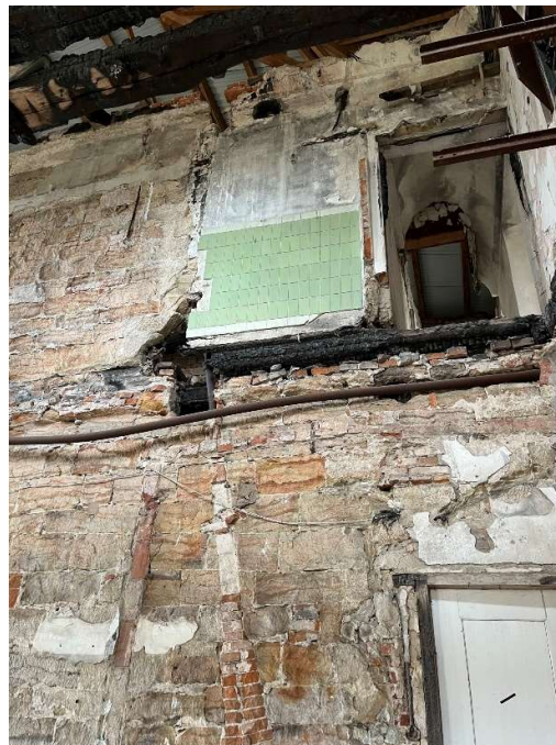
Obrázek 97 - Pohled na odhalené zdivo bez omítky, zbývající část keramické dlažby ve 2.NP
