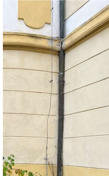
Obrázek 171 - Pohled (dvorní) na začlenění dešťového svodu do římsy
