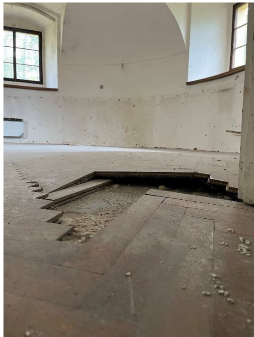
Obrázek 150 - Zvlněné dřevěné parkety v místnosti č. 0.28
