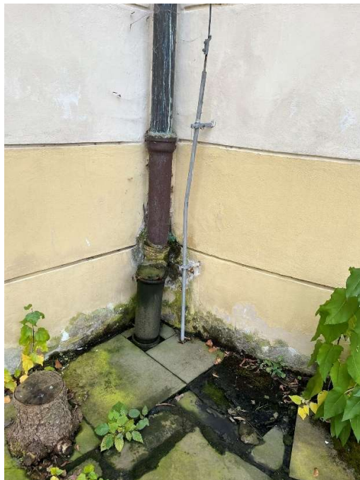
Obrázek 157 - Dešťový svod složený z několika materiálů, prvků a tvarovek, přítomnost mechů a plísní v okolí spodní části dešťového svodu
