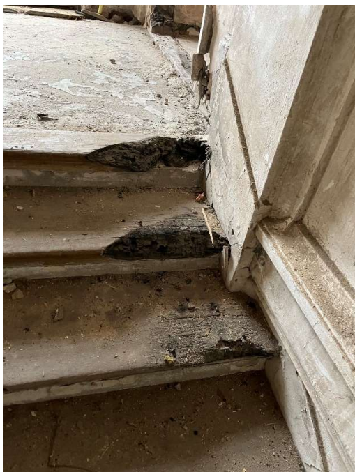
Obrázek 118 - Ohořelé schodišťové stupně do 2.NP
