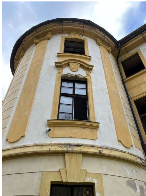
Obrázek 93 - Pohled na trhliny v okolí oken, povrchové rozrušení omítky, poruchy a trhliny v omítce patrové římsy SZ rondelu
