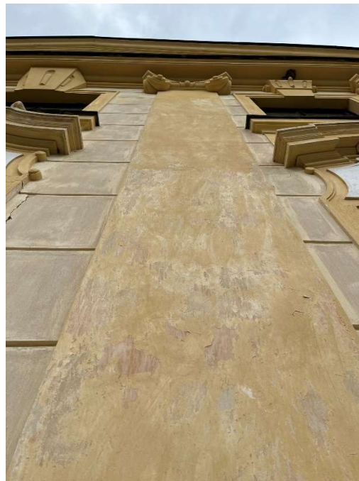
Obrázek 131 - Povrchové poškození fasádní omítky na jižním průčelí
