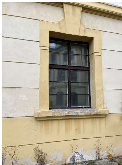
Obrázek 129 - Znamky po stékající dešťové vodě v parapetní oblasti - dvorní fasáda
