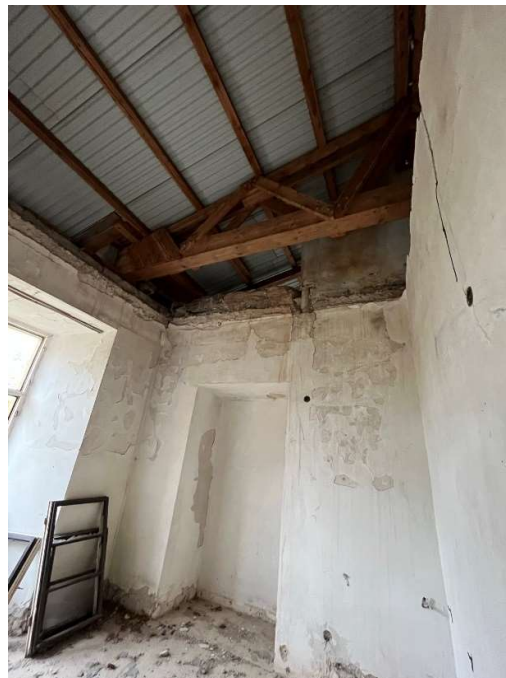
Obrázek 114 - Chybějící stropní konstrukce nad místností v 2.NP
