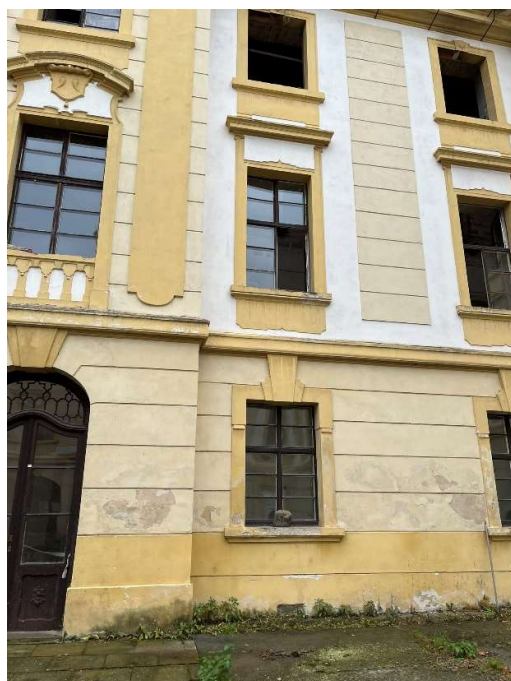
Obrázek 128 - Pohled na povrchově poškozenou fasádní omítku na dvorní fasádě jižní části
