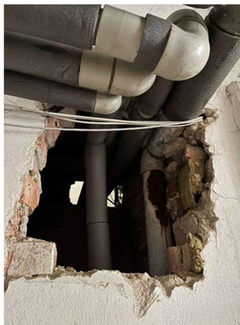
Obrázek 49 - "Nové" vodovodní potrubí – SV, TV, CK, požární potrubí
