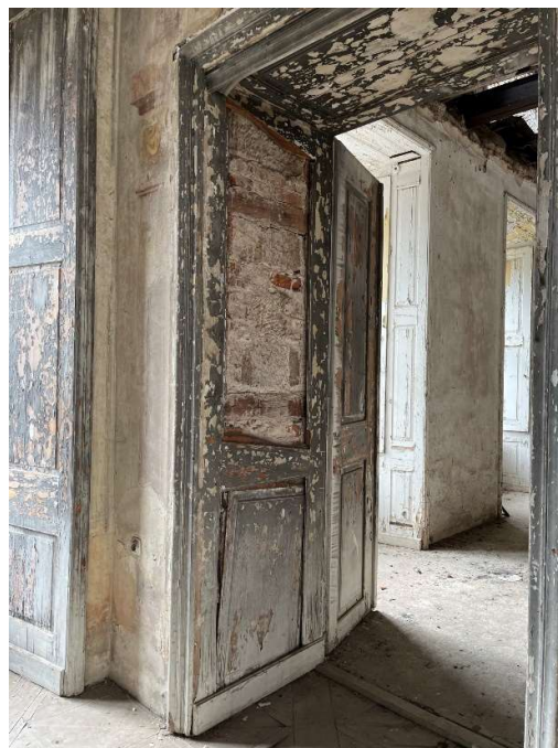
Obrázek 145 - Ohořelé dřevěné prvky výplně otvoru, destrukce a chybějící části deštění
