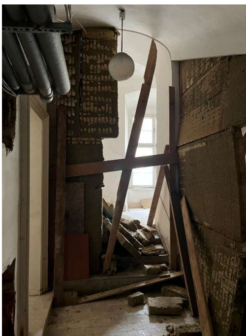
Obrázek 149 - Rozpad dělicí konstrukce u severního schodiště v přízemí
