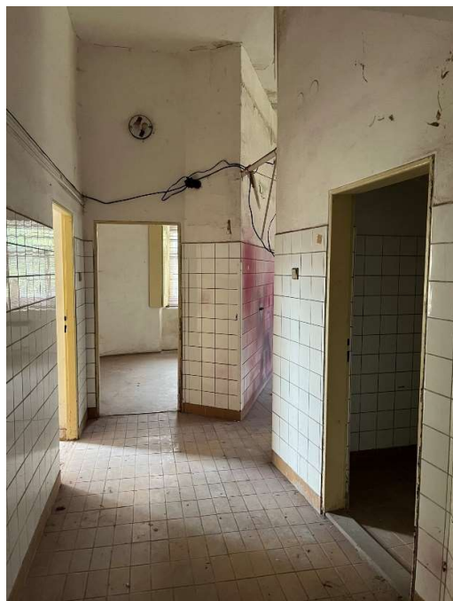
Obrázek 144 - Chybějící dveřní křídla v ocelových zárubních
