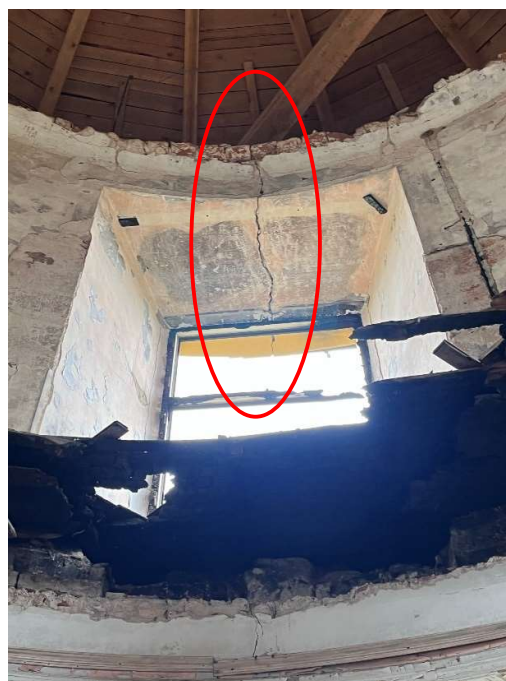
Obrázek 109 - Trhlina v nadpraží okna v místnosti č. 2.12 (SV rondel)
