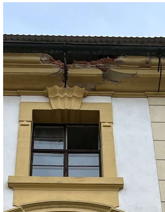
Obrázek 173 - Pohled na vypadané kusové stavivo korunní římsy
