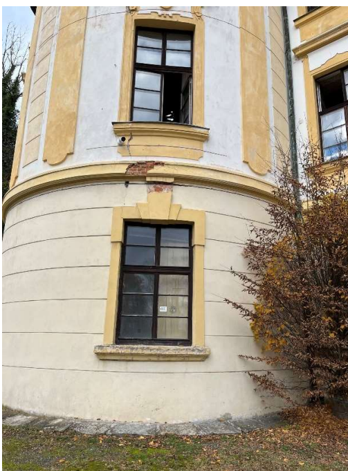
Obrázek 132 Nezapravená omítka po sepnutí a stehování trhlin
