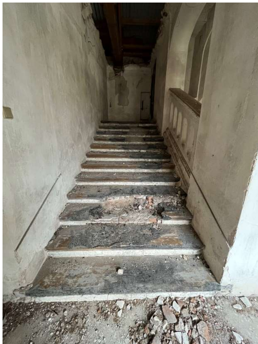
Obrázek 120 - Ohořelé schodišťové stupně do podkrovní
