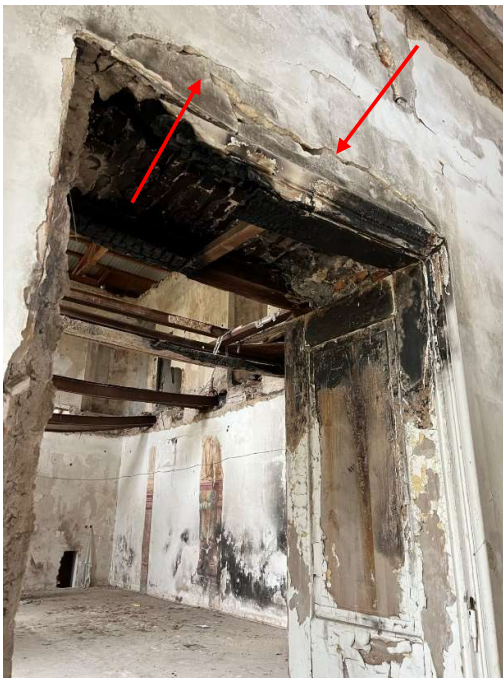
Obrázek 107 - Porušení nadpraží u dveří mezi místnostmi č. 1.30 a 1.31
