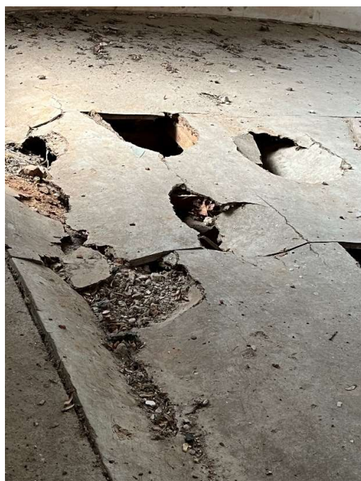
Obrázek 152 - Propadlá podlaha z desek na bázi dřeva v místnosti č. 1.29
