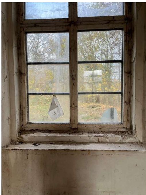
Obrázek 135 - Chybějící povrchová úprava parapetu, opadavý nátěr rámu, rozrušená omítka po obvodu okenního otvoru
