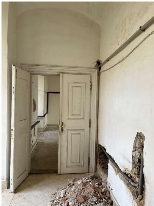
Obrázek 96 - Nezapravené rýhy ve zdivu na chodbě v přízemí východní části objektu
