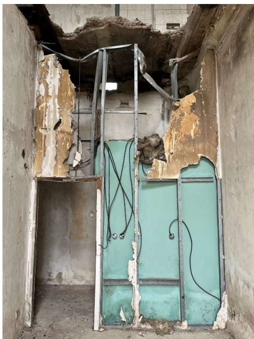
Obrázek 147 - Destrukce lehké dělicí příčky v 1.NP – pohled z pokoje
