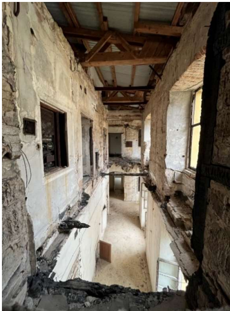
Obrázek 30 Chybějící vodorovné konstrukce v 1.NP a 2.NP
