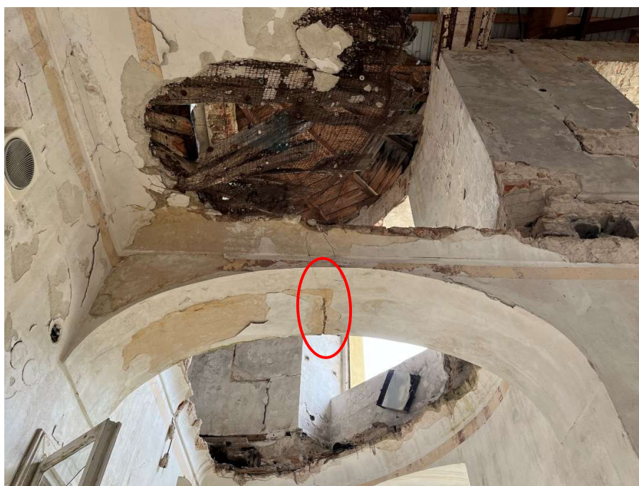
Obrázek 112 - Trhlina v klenbovém pásu v místě JZ čtvrtálcového výstupku v 1.NP
