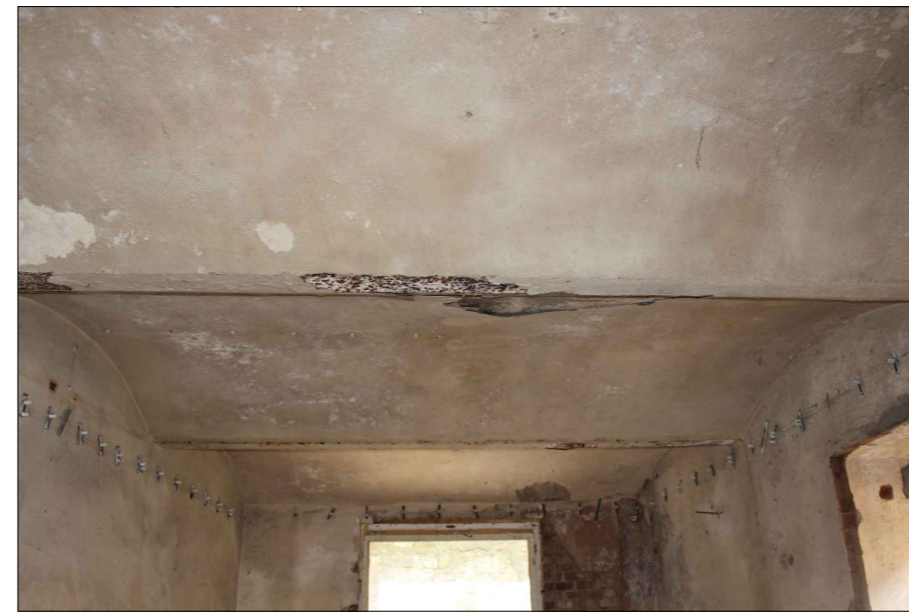
NOSNÍKY NAPADENÉ KOROZÍ
