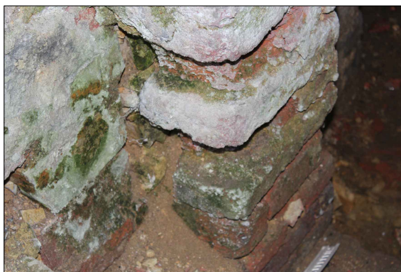
PLÍSŇ NA ZDIVU
