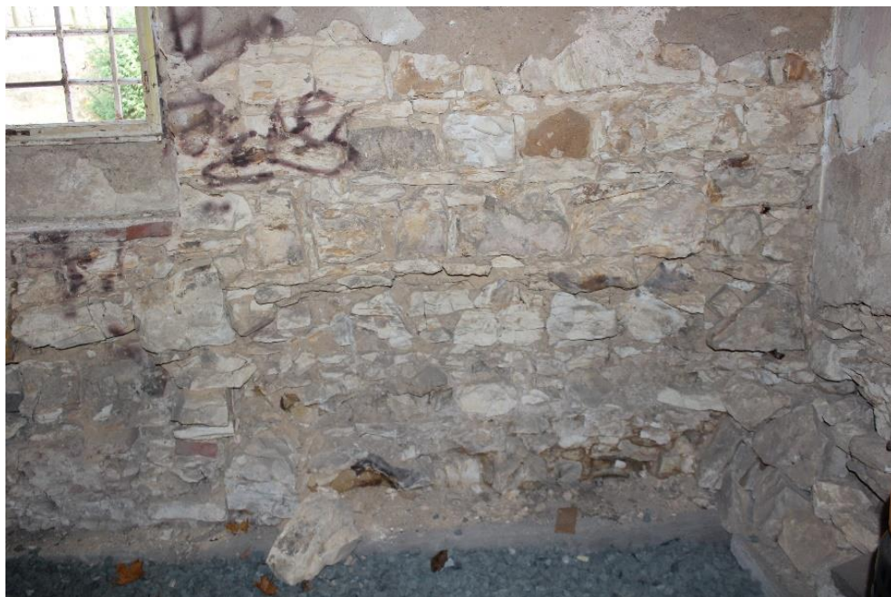
Obrázek 28 – Opadaná omítka v místě průjezdu budovou
