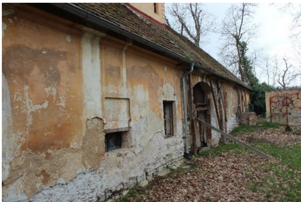
Obrázek 26 – Opadaná omítka na zdivu východní strany
