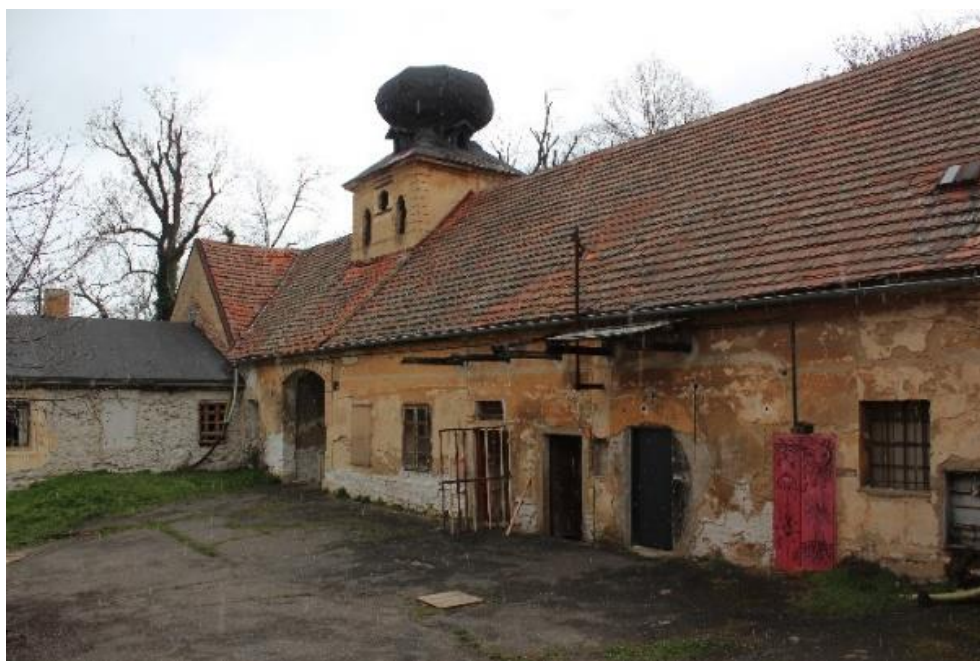
Obrázek 25 – Opadaná omítka na zdivu západní strany
