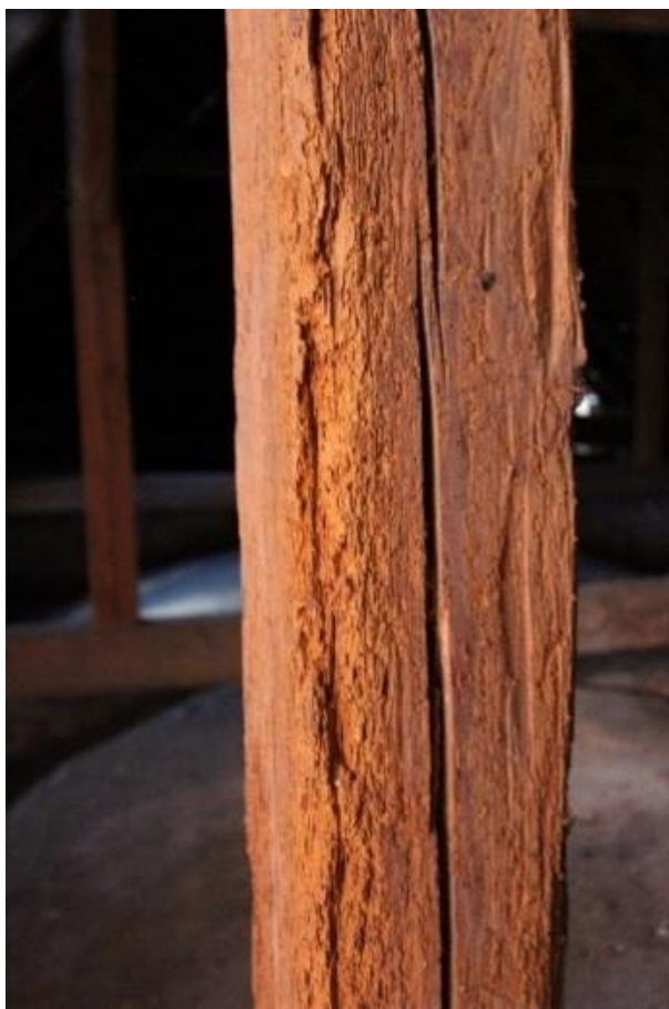
Obrázek 40 – Pohled na výsušnou trhlinu a napadení dřevokaznými škůdci
