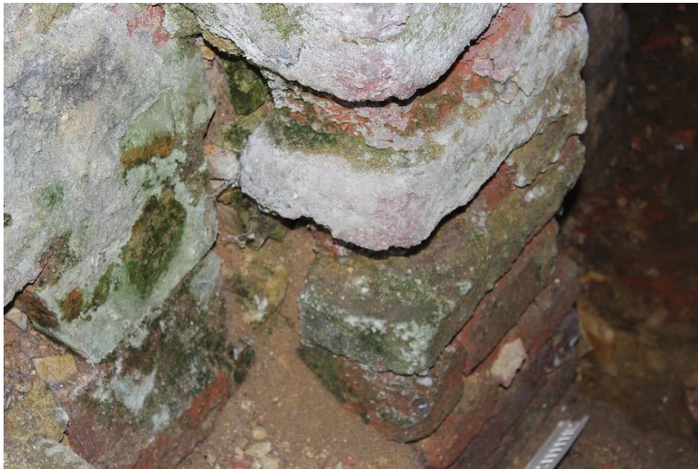
Obrázek 30 – Zdivo napadené řasami v podsklepené části budovy
