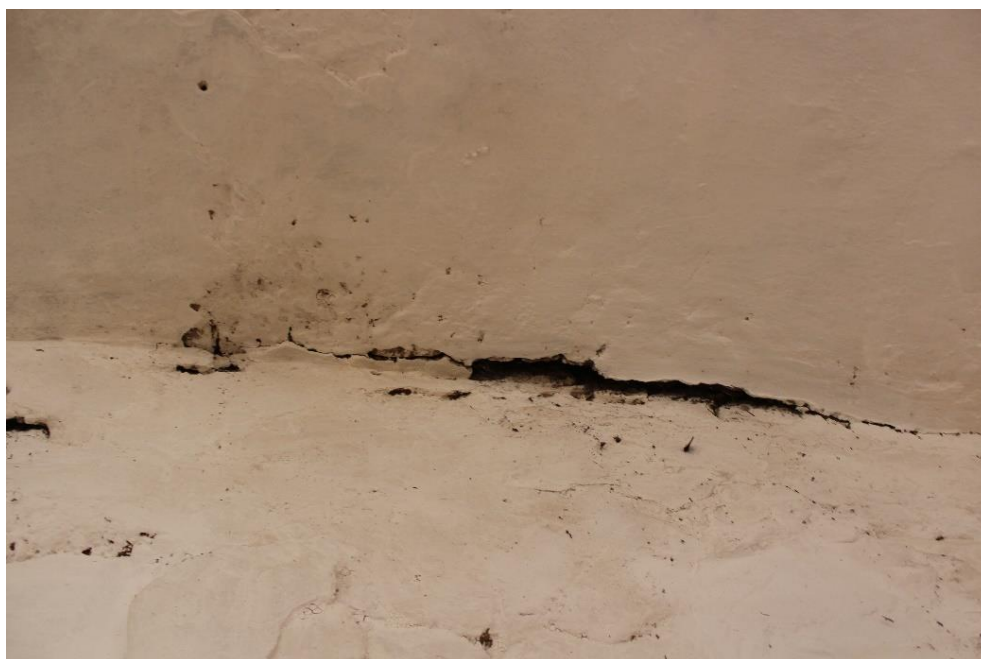
Obrázek 31 – Trhlinka na čele valené klenby
