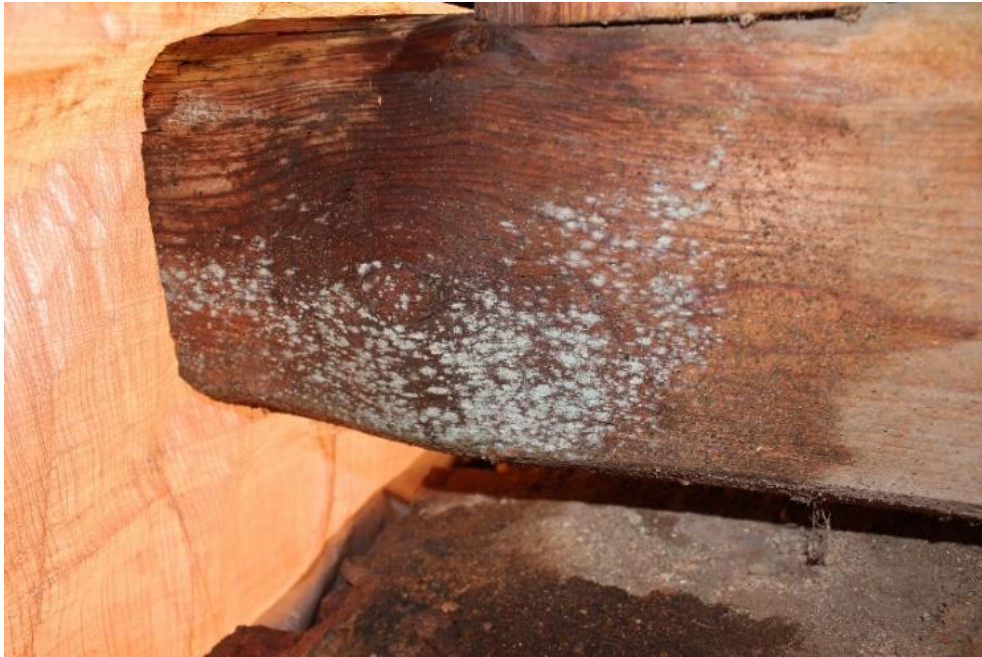
Obrázek 37 – Pozednice poškozená vodou
