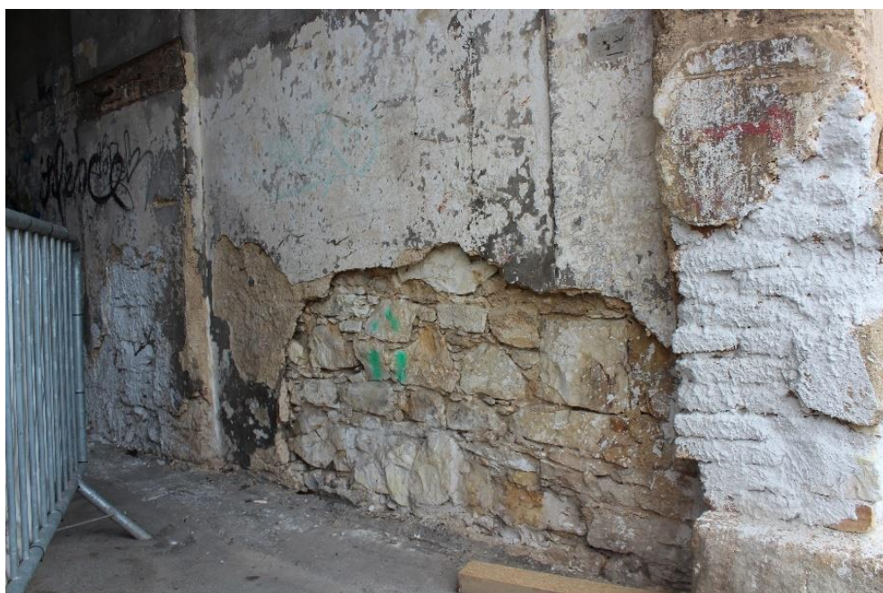
Obrázek 27 – Opadaná omítka na interiérové straně objektu
