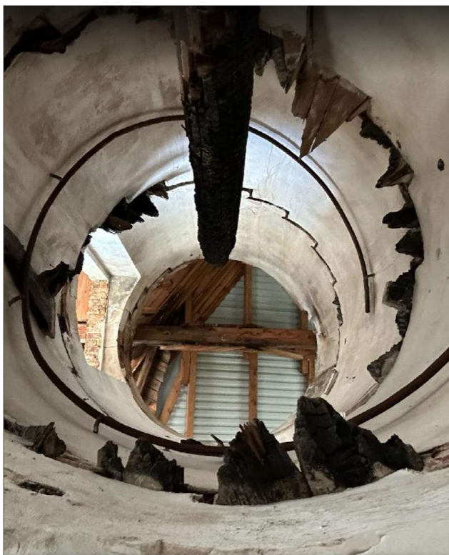
Obrázek 43- Vyhořelé vedlejší schodiště
