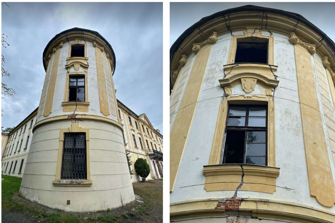
Obrázek 35- Svislé trhliny na jihozápadní nárožní věžici
