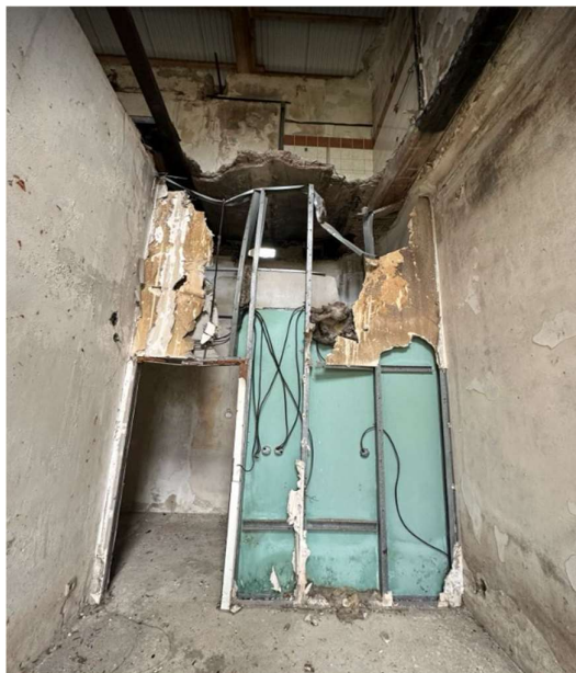
Obrázek 49- Porušení sádkartonové montované příčky
