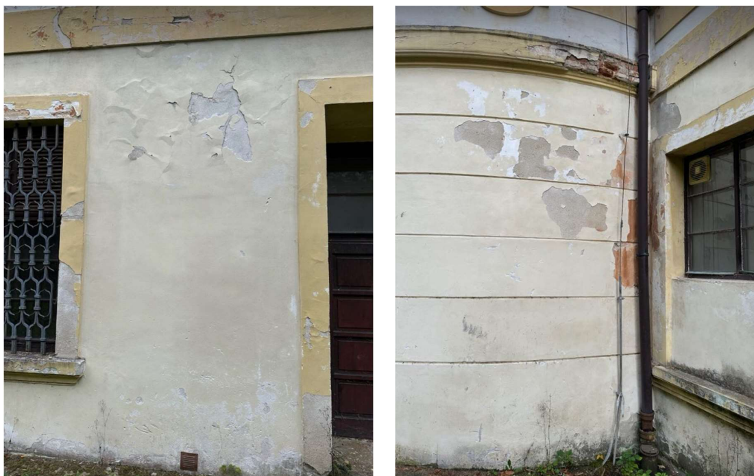
Obrázek 53- Poškození vnější omítky
