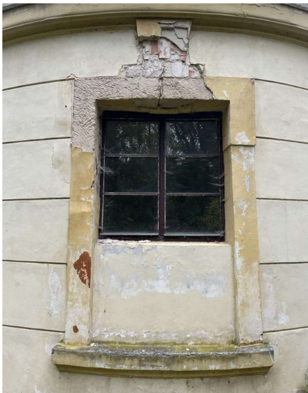
Obrázek 36- Svislá trhlina v nadpraží okenního otvoru na severozápadní nárožní věžici
