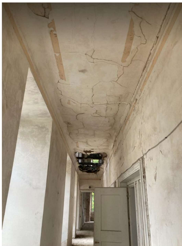
Obrázek 40- Trhliny na podhledu
