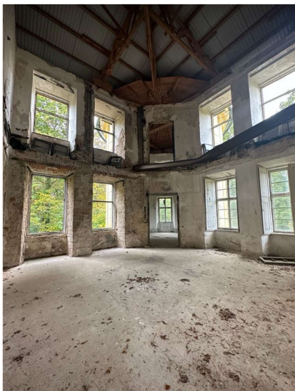
Obrázek 42- Chybějící stropní konstrukce v rohové místnosti u nárožní věžice
