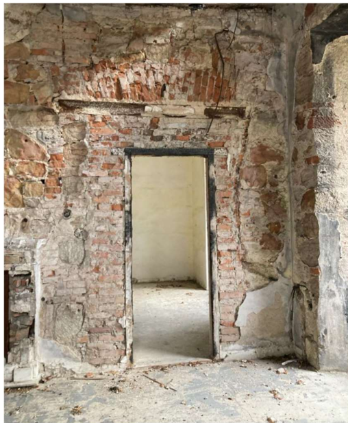
Obrázek 47- Porušení příčky, chybějící omítka
