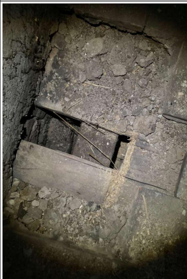
obr. /17/ Fotografie místa sondy S2 po rozřezání záklopu
