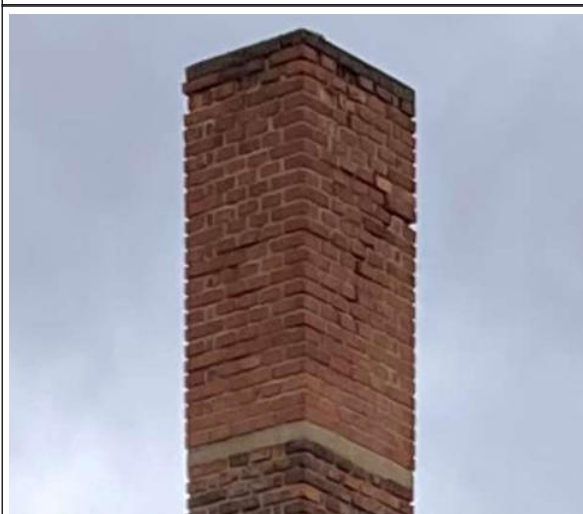
obr. /45/ Poruchy komínového tělesa způsobené nerovnoměrným rozložením teplot
