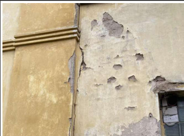
obr. /51/ Trhlina v přístavku v severovýchodní části
