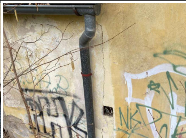
obr. /52/ Trhlina v přístavku v severovýchodní části
