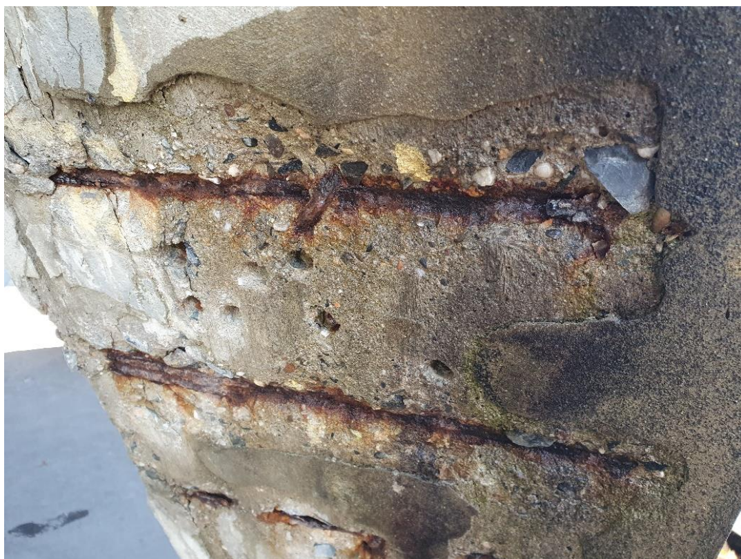
Obrázek 6: Degradace výztuže vystavené povětrnostním vlivům a agresivním látkám, Strahovský stadion
