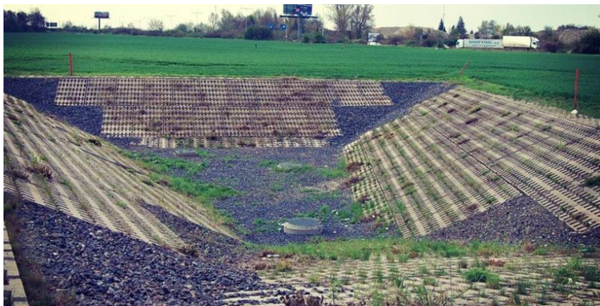
Obr. č. 16 Retenční vsakovací nádrž se vsakovacím vrtem
