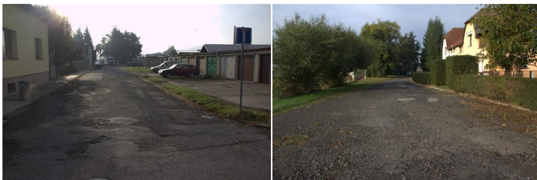
Obrázek 14 - (1) První část ulice U Trati s řadovými garážemi; (2) Druhá část ul. s přílehlými zelenými plochami (zdroj: autor)
