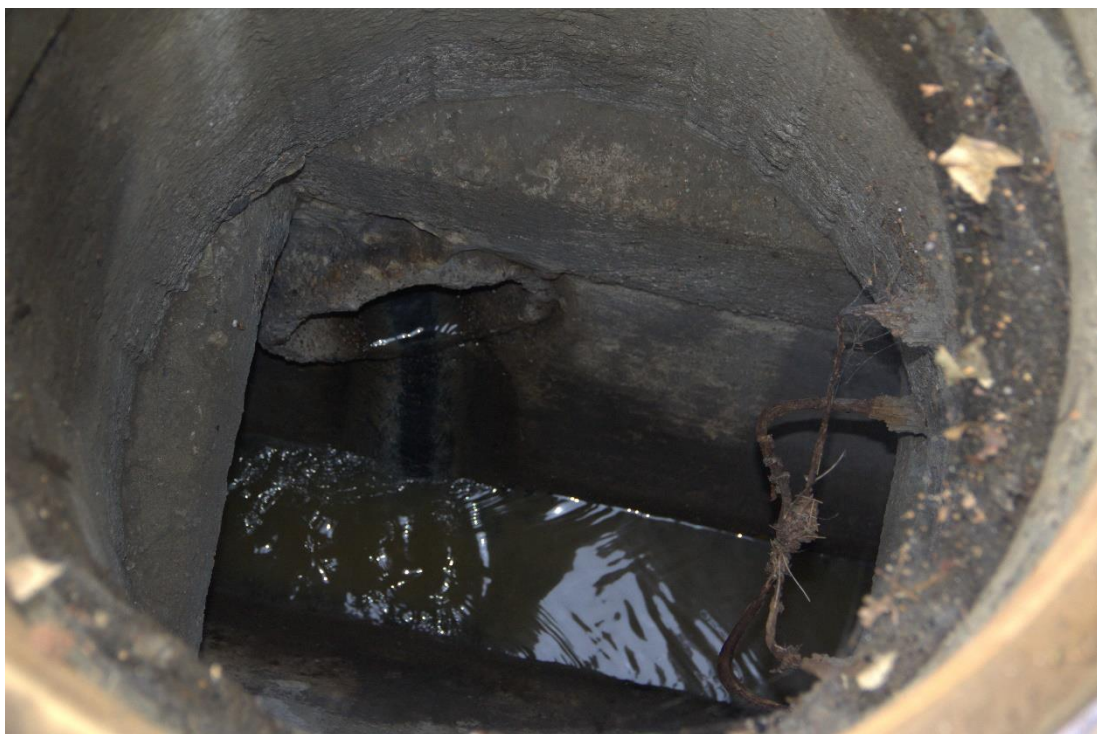
Obrázek 20 - Špatně řešený nátok ze Smetanovi ulice (zdroj: autor)
