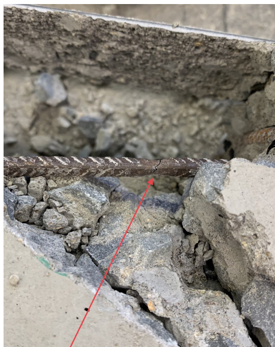
Obr. 2.63: Přetržená ohybová výztuž v místě smykové trhliny
