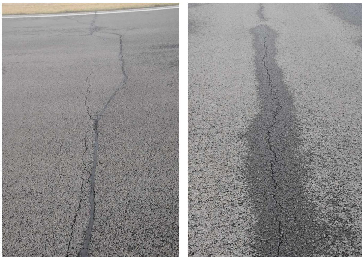
Obrázek 1: Příčné trhliny krytu (zdroj: fotodokumentace lokality)
