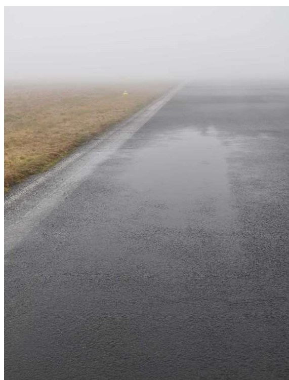
Obrázek 5: Úsek špatného odtoku dešťových vod (zdroj: fotodokumentace lokality)
