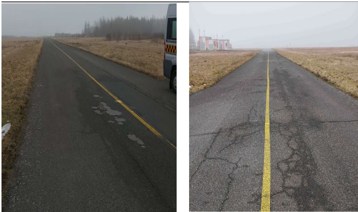
Obrázek 7: Síťové trhliny a lokální výtluky (zdroj: fotodokumentace lokality)
