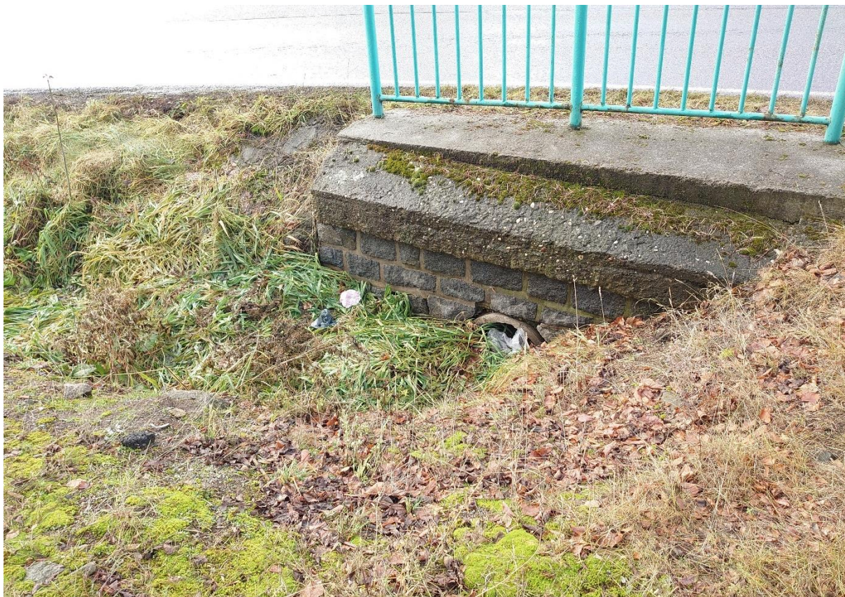
Fotografie č.19 – zanesený výtok stávajícího propustku v obci Jablonná
