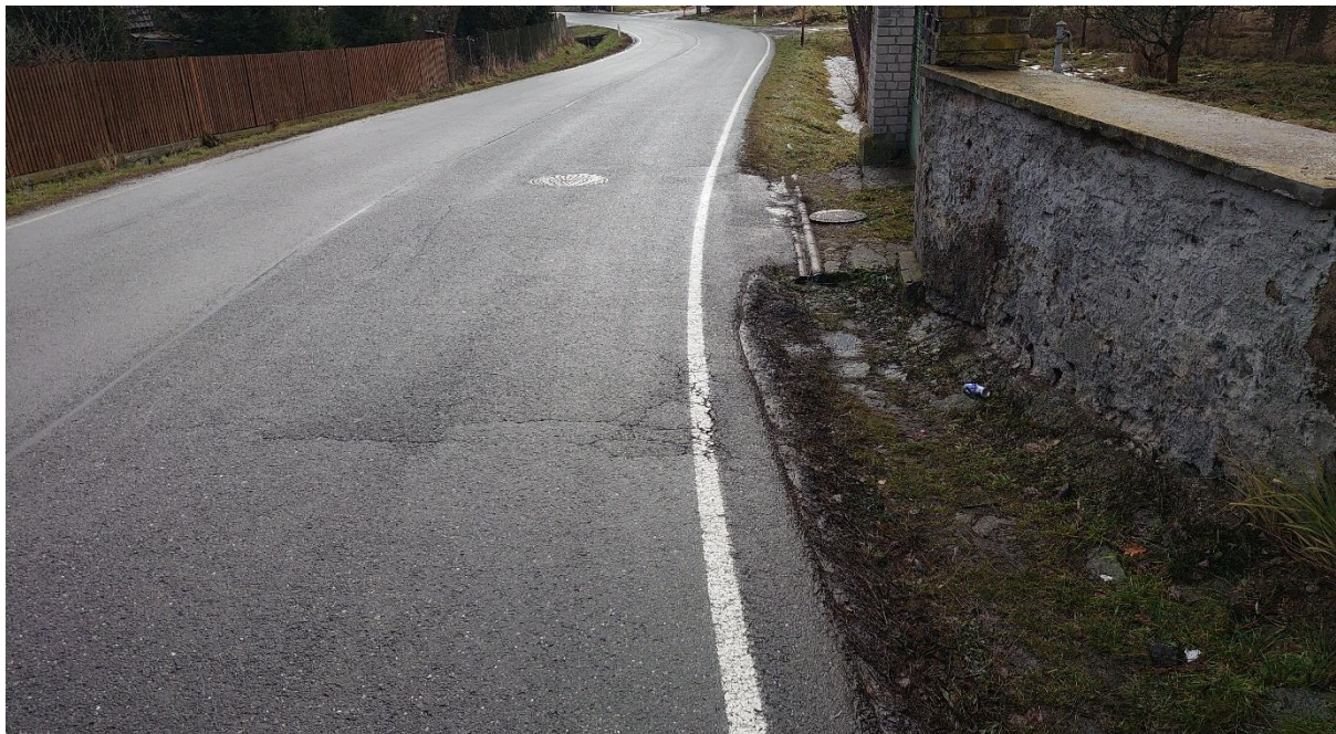
Fotografie č. 15 – poruchy vozovky v obci Jablonná (mozaikové a příčné trhliny), pohled proti směru staničení
