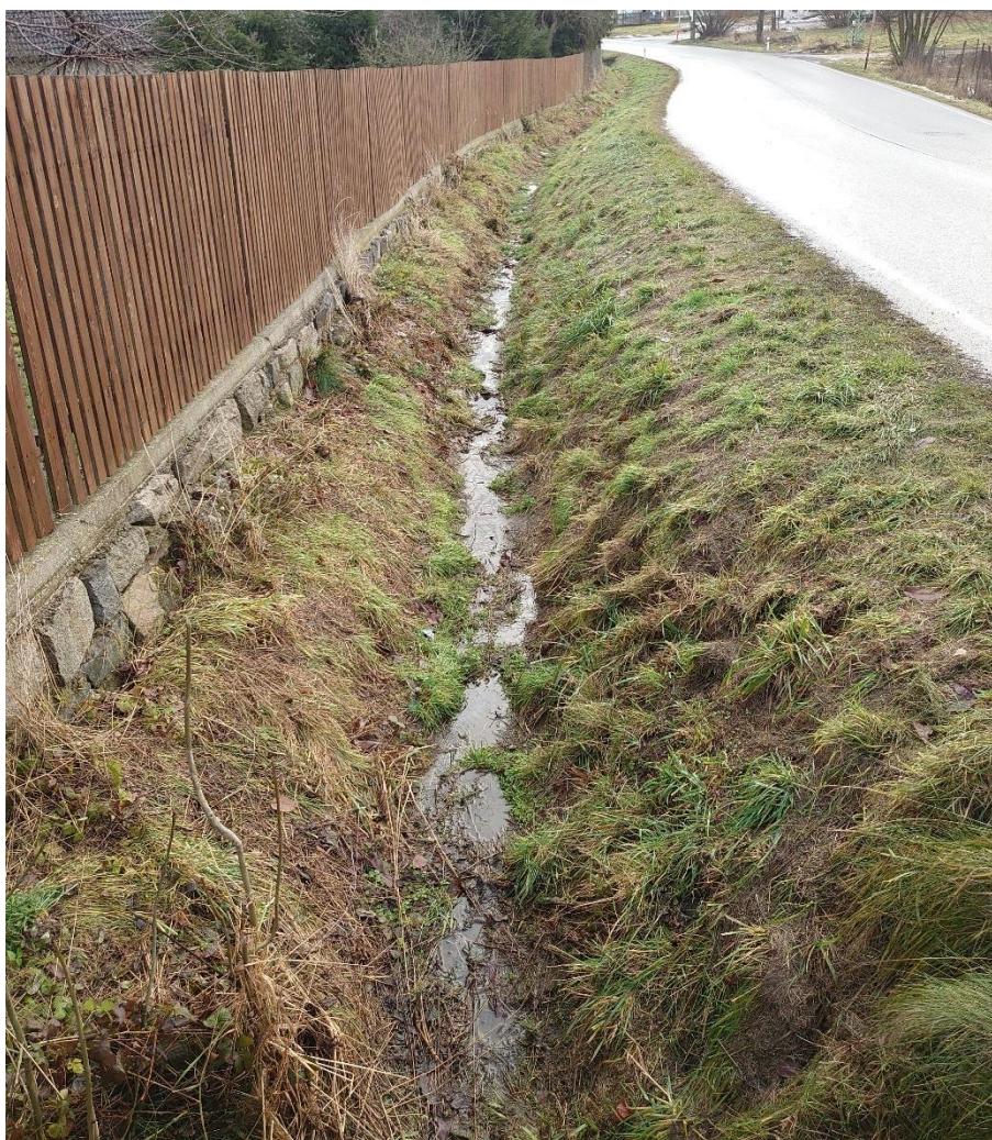
Fotografie č. 16 – zanesený odvodňovací příkop s příkopovou tvárnicí v obci Jablonná, pohled proti směru staničení
