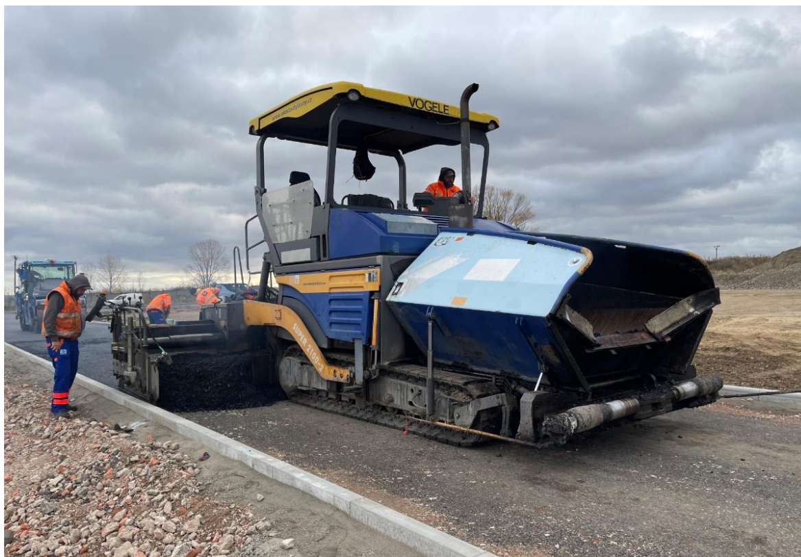
Obrázek 56 - PÁSOVÝ FINIŠER VÖGELE SUPER 2100-2 S LIŠTOU AB 600 TV NA STAVBĚ [vlastní zdroj]
