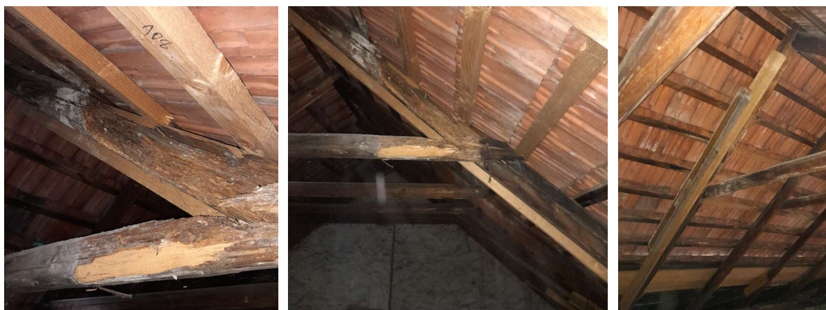
Obrázek 24 – Fotografie poškozených prvků krovu
