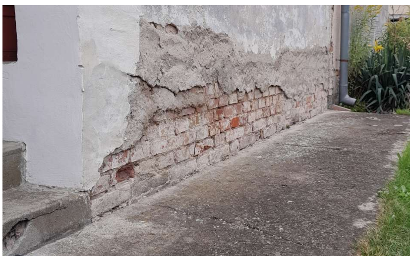
Obrázek 18 – Povrchová degradace soklu západní fasády
