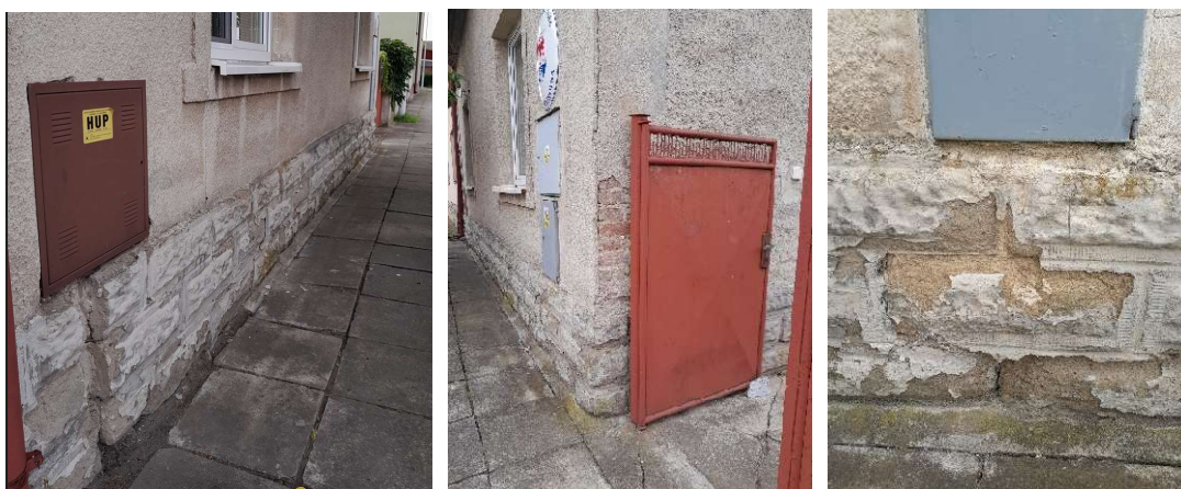
Obrázek 16 – Povrchová degradace soklu severní fasády
