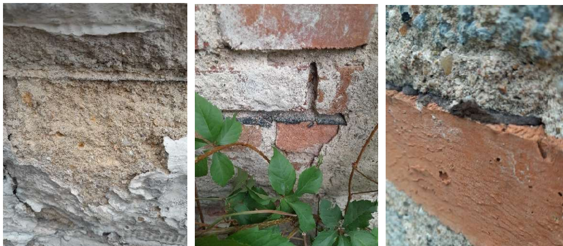
Obrázek 12 – Fotografie stávající hydroizolace
