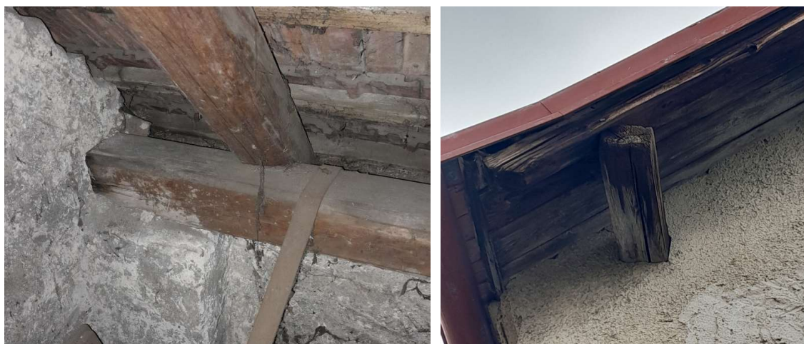
Obrázek 25 – Poškození dřevěných prvků přesahu střechy
