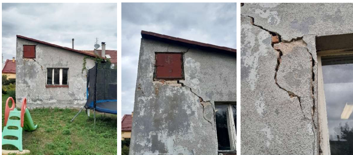
Obrázek 22 – Trhliny v obvodovém zdivu jižní fasády
