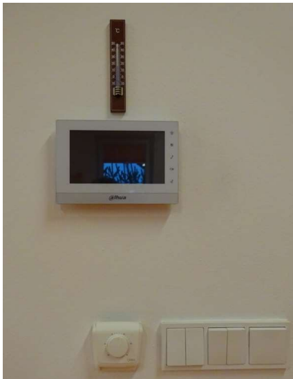
Obrázek 37, Regulační prvky v objektu
