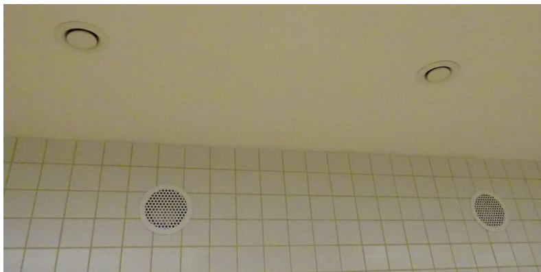
Obrázek 31, Koncové prvky vzduchotechniky v umývárkách – talířové ventily a dýzy
