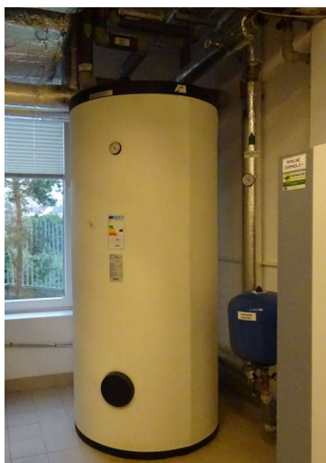
Obrázek 36, Zásobník teplé vody v technické místnosti 1.NP
