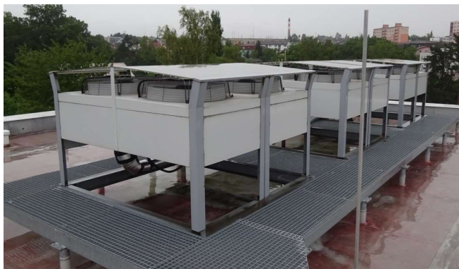
Obrázek 34, Tepelná čerpadla voda-vzduch – část na střeše 2.NP
