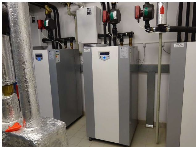
Obrázek 33, Tepelná čerpadla voda-vzduch – část v technické místnosti v 1.NP
