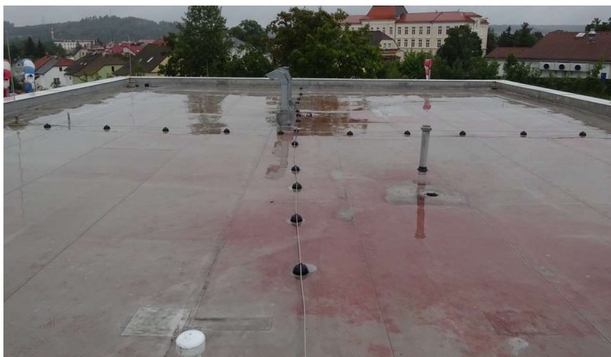
Obrázek 6, Nepochozí střecha s asfaltovými pásy
