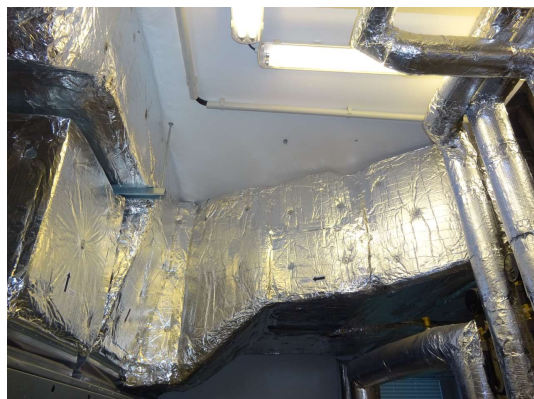
Obrázek 30, Přívod čerstvého vzduchu do budovy
