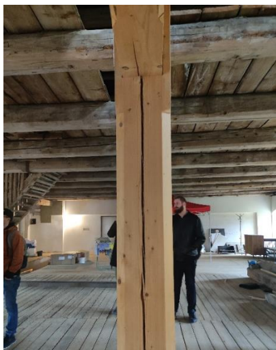
Obrázek 6 Trhlina způsobená vysycháním- Pivovar Chyše
