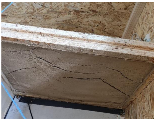
Obrázek 69 Trhliny v hliněné omítce
