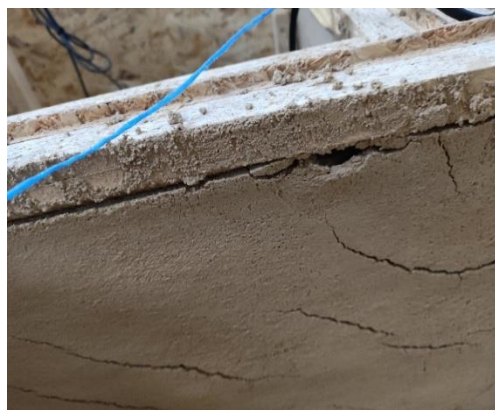
Obrázek 68 Odtržení vrstvy omítky od vrchního rámu
