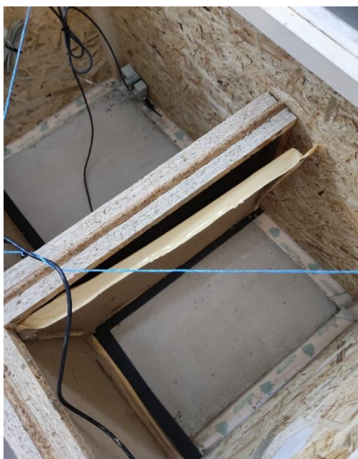
Obrázek 67 Odklonění celé vrstvy omítky od desky
