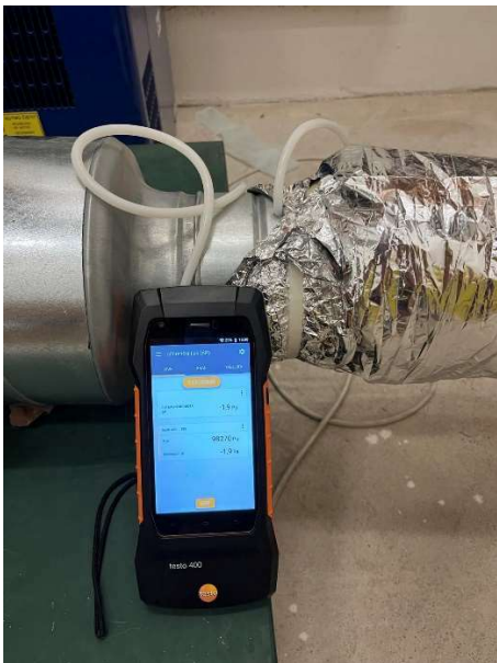
Obr. 22) Měření diferenčního tlaku za osovým přechodem
