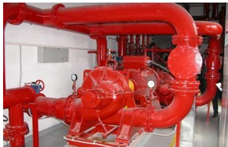
Obr. 7: Čerpací zařízení s elektromotorem [13]
