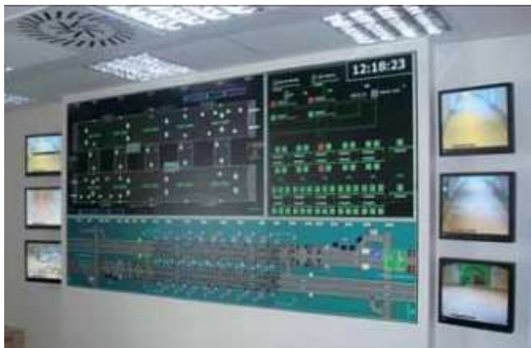
Obr. 11 Velkoplošný zobrazovací systém s monitory videodohledu
