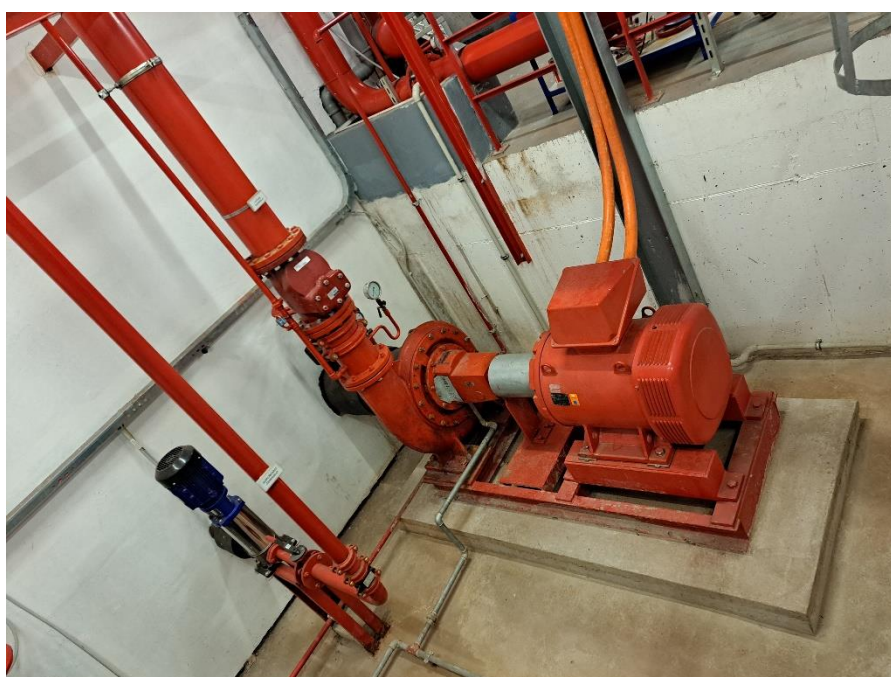
Obrázek 3 - Doplnovací čerpadlo a čerpadlo s elektromotorem
