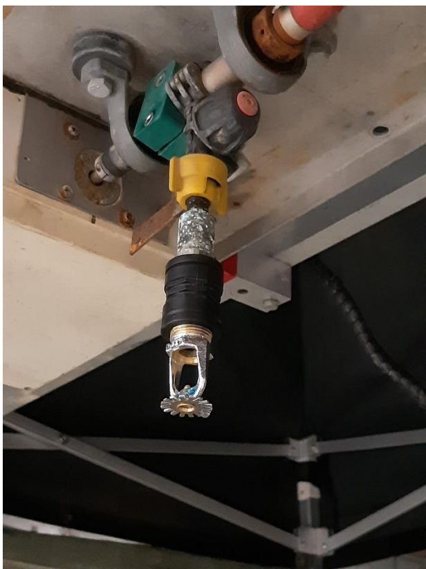
Obrázek 74 – Namontovaný sprinkler C
