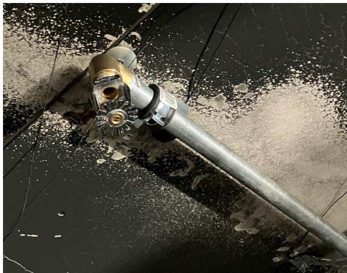
Obrázek 23 - Namontovaná sprinklerová hlavice
