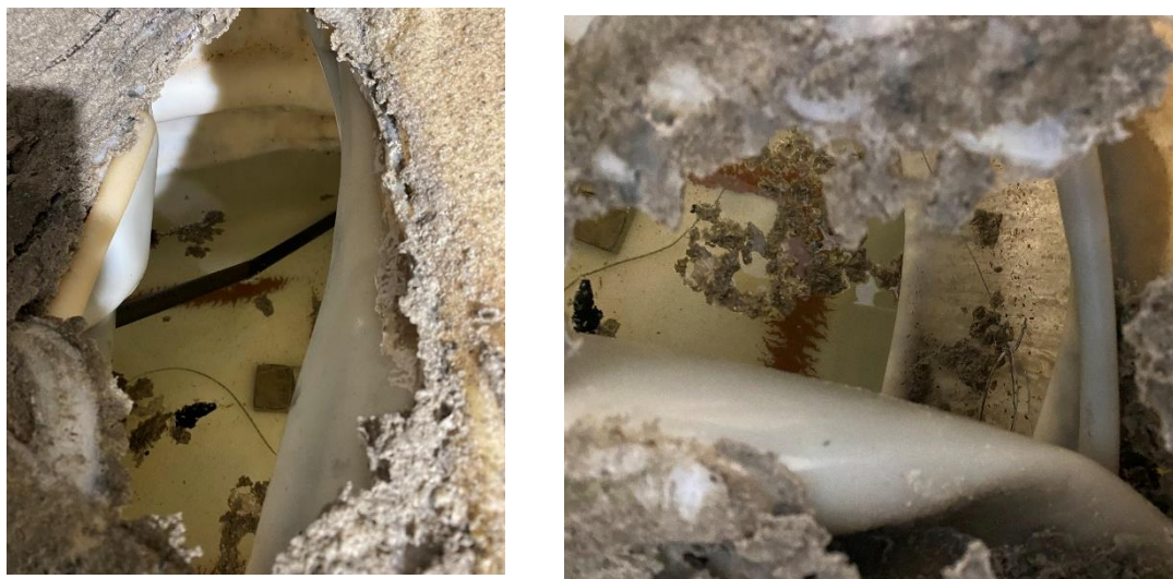
Obrázek 68 – Malé množství vody uvnitř nádrže
