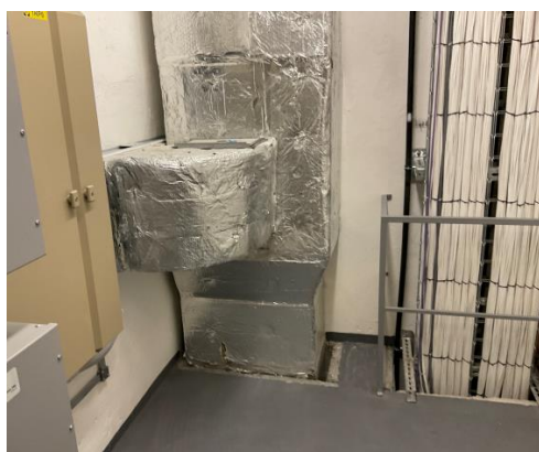
Obr. 32 — Fotografie rozvodu VZT 6.NP
