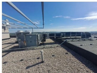
Obr. 24 — Fotografie ventilátoru a potrubí HVAC
