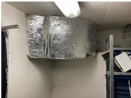
Obr. 30 — Fotografie rozvodu VZT 2.PP
