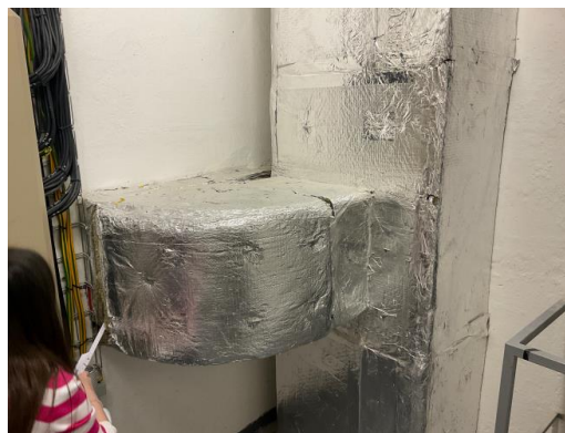
Obr. 31 — Fotografie rozvodu VZT 3.NP
