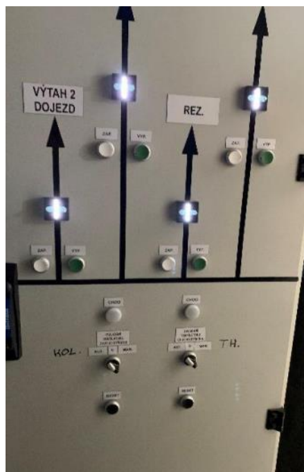
Obr. 26 — Ovládací panel v požární rozvodně [3]
