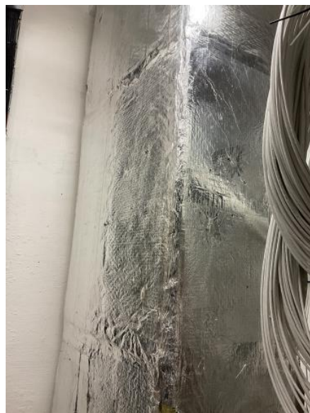
Obr. 35 — Fotografie rozvodu VZT 12.NP
