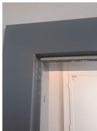
Obr. 21 — Chybějící těsnění na zárubni (3.NP)
