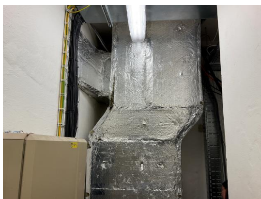
Obr. 33 — Fotografie rozvodu VZT 10.NP
