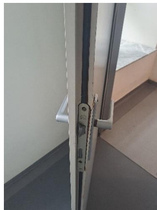
Obr. 100— Poškozené dveřní křídlo 6.NP
