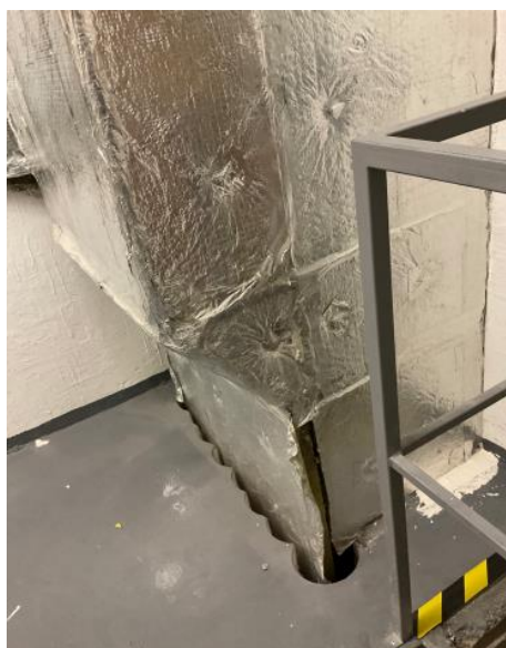
Obr. 34 — Fotografie rozvodu VZT 10.NP
