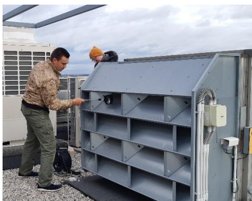
Obr. 77 — Průběh měření rychlosti proudění nasávaného vzduchu v nasávacím otvoru
