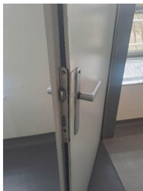
Obr. 18 — Poškozené dveřní křídlo (6.NP)
