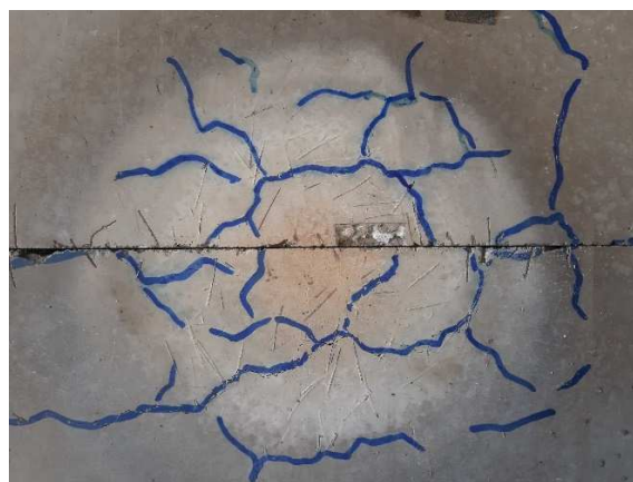
b) Panel po zkoušce
