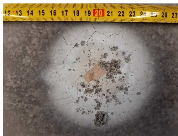
b) Panel po zkoušce
