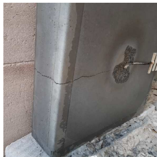
b) Panel po zkoušce
