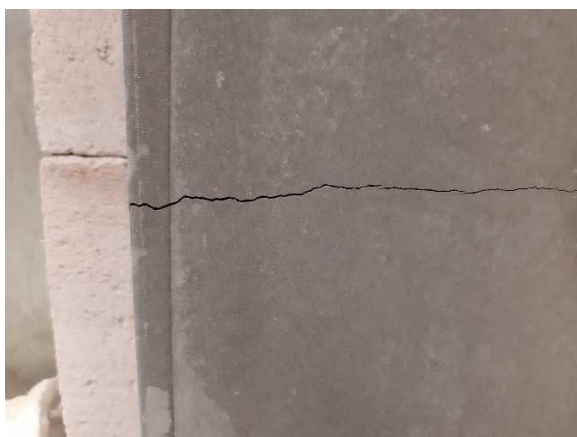
a) Panel po zkoušce
