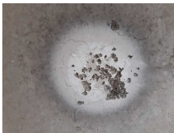
b) Panel po zkoušce
