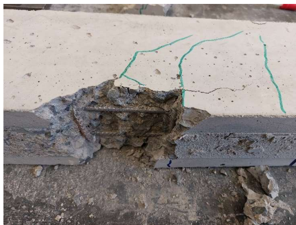
Obrázek 71 Pohled na neporušenou výztuž nosíku T8
