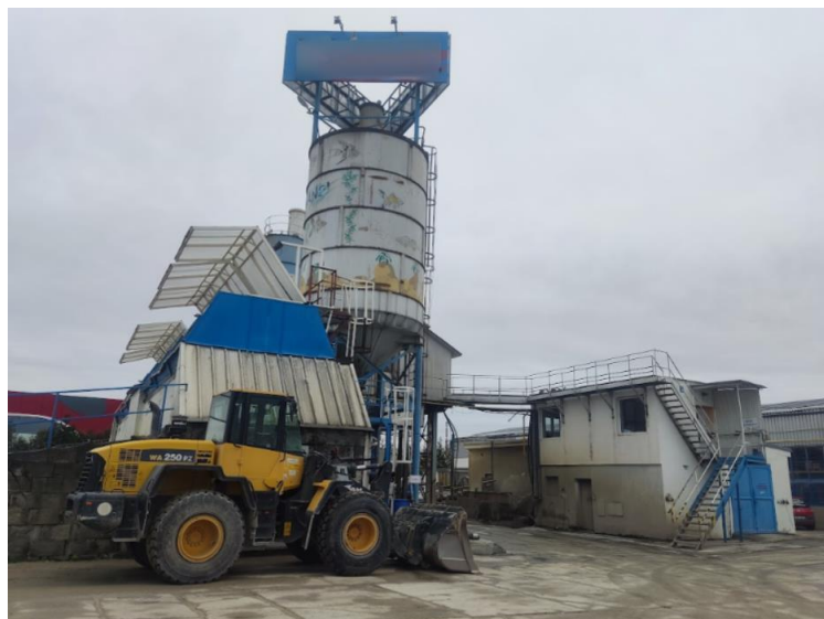
Obr. 39 – Zařízení betonárny včetně nakladače, tvorba vlastní
