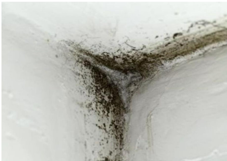
Obrázek 2.8.9 – Ukázka plísně na stropu [34]
