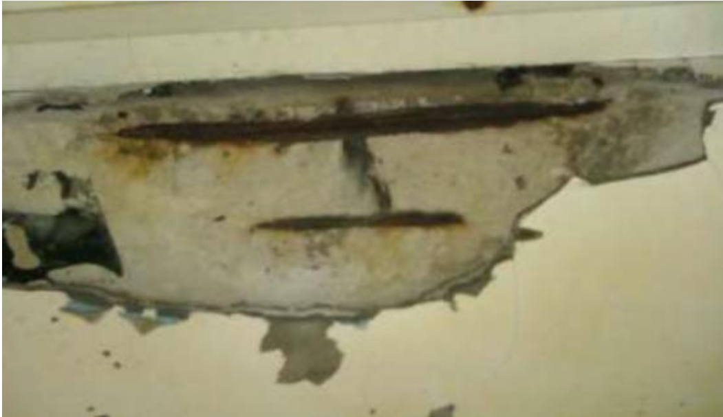
Obrázek 2.8.3 – Odhalená výztuž v desce [32]
