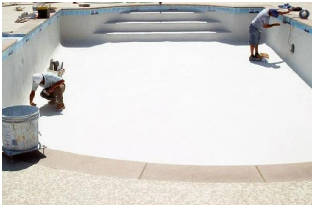
Obrázek 2.6.4 – Bílá omítka na betonovém bazénu [28]
