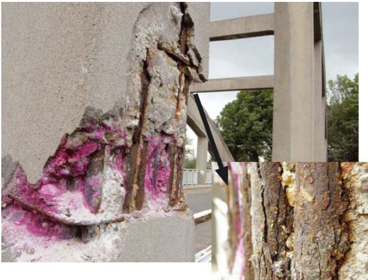
Obr. 24 - Konstrukce zasažená karbonatací. Hloubka zkarbonatované vrstvy zvýrazněna pomocí roztoku fenolftaleinu. [61]
