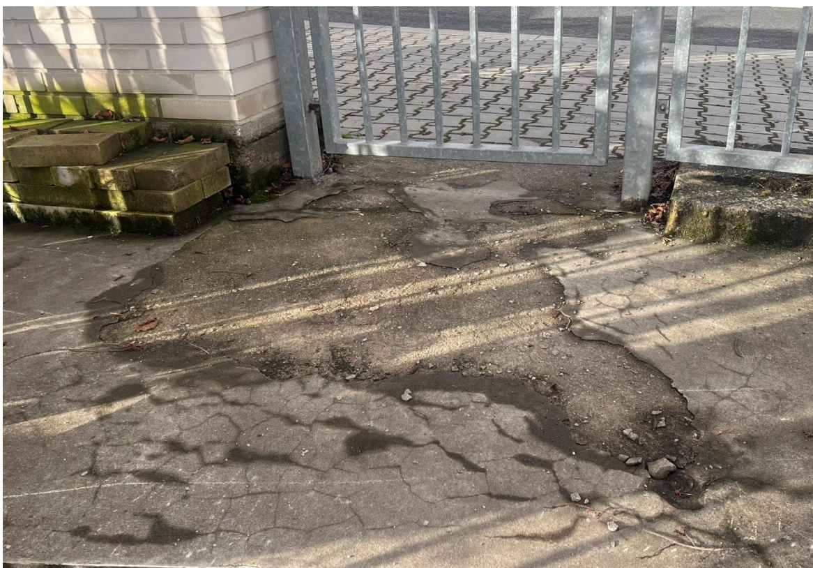
Obr. 15 - Popraskání povrchu betonové desky působením mraza za přítomnosti vody
