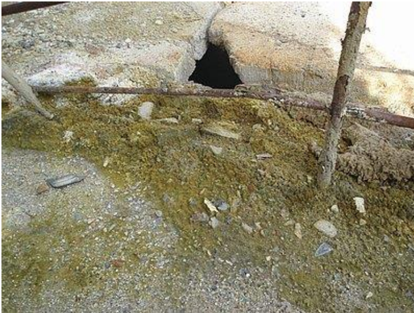
Obr. 21 - Degradace betonu při působení síranové koroze [61]
