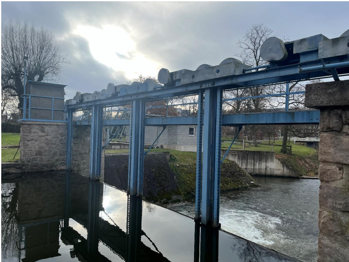
Foto 10: Pohled na pohybovací mechanismy stavidlového jezu
