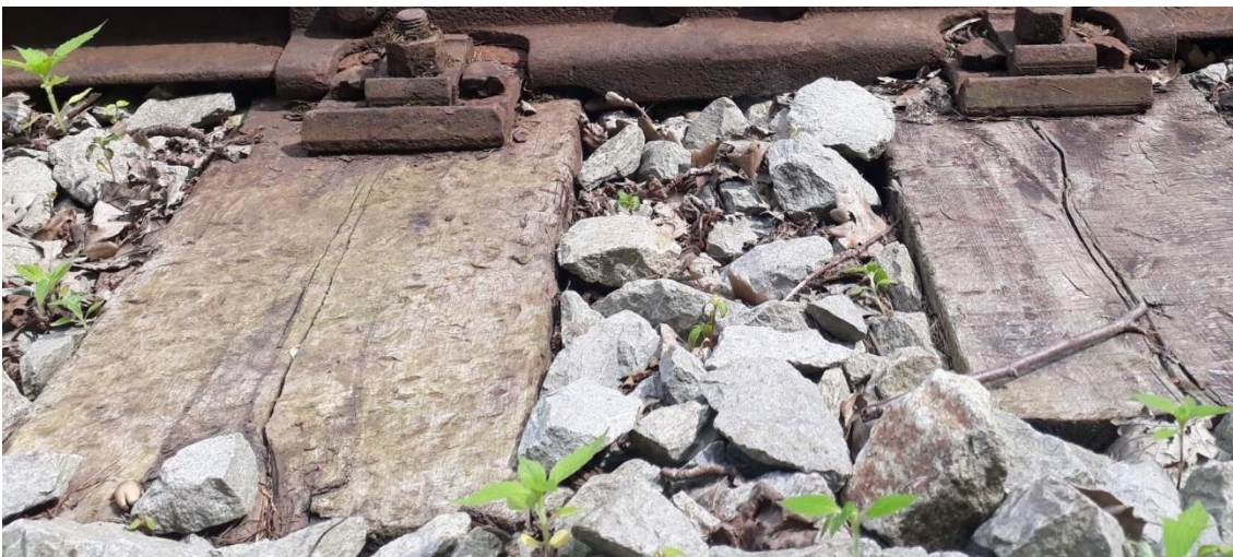
Obr. 5: Viditelné otláčení pražce od kolejového lože na jeho původní ložné ploše [Zdroj: Autor]
