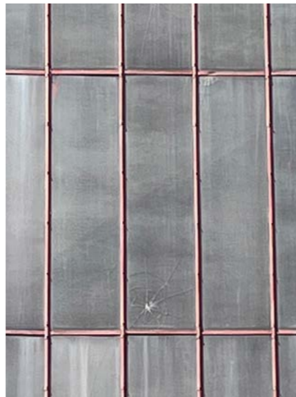
Bílá Tepna, bývalá budova Textilních podniků Náchod, dnes ruína, detail okna
