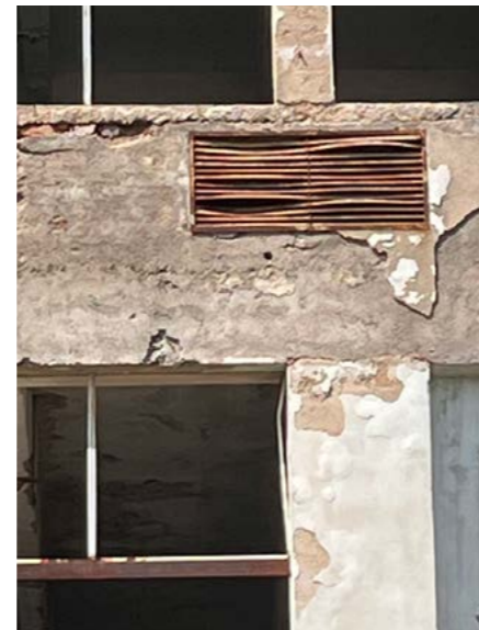
Bílá Tepna, bývalá budova Textilních podniků Náchod, dnes ruína, detail fasády
