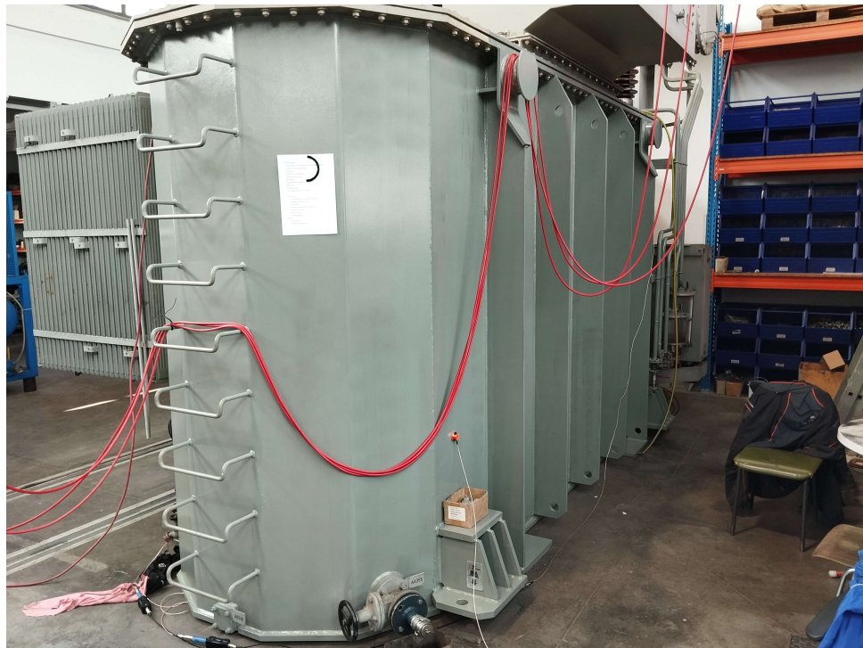
Obrázek 5.23: Měřený transformátor s rozmístěnými ultrazvukovými sondami (Hesia Bratislava)
