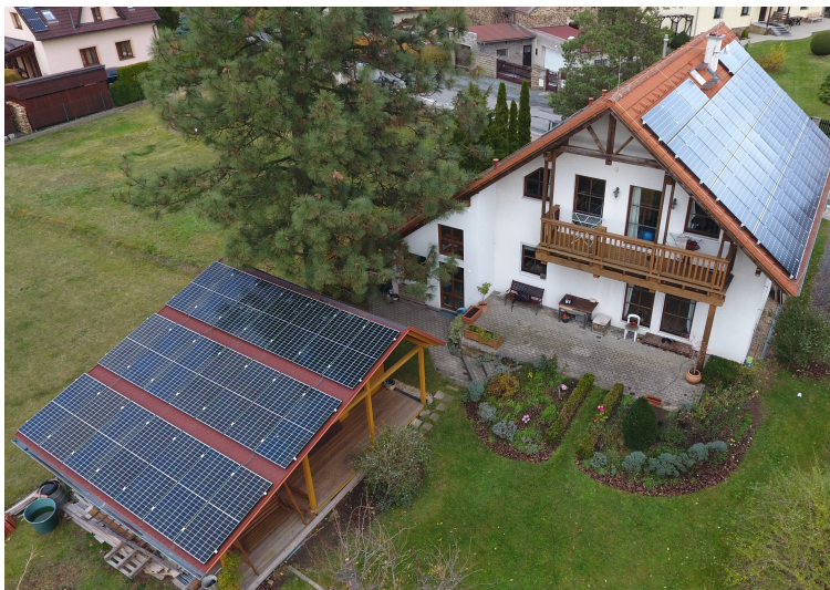
Obrázek 4.6: Obě fotovoltaické instalace na adrese Bezručova 1264/8. Zdroj: Vlastní
