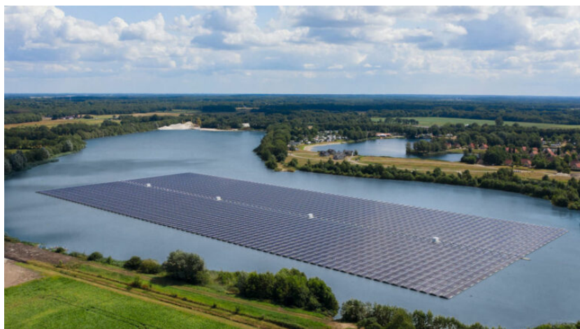
Obrázek 3.5: Plovoucí fotovoltaická elektrárna na jezeře Silbersee III [33]
