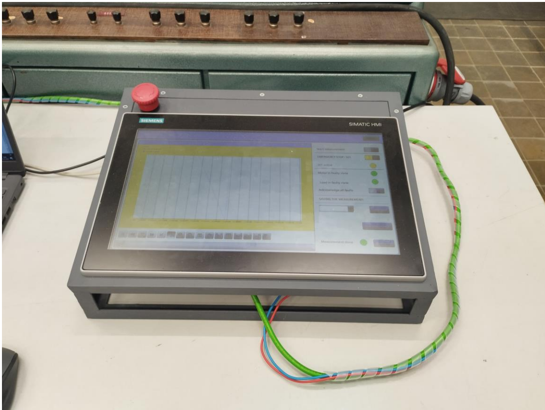
Obr. 3-7 Detailní fotografie HMI panelu.
