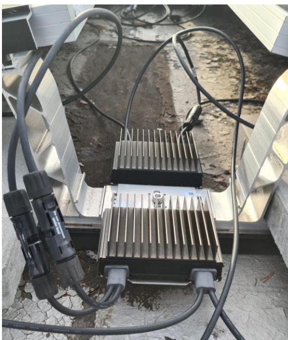
Obrázek 26 – detail instalovaných optimizérů a jejich zapojení na střeše hal ČVUT
