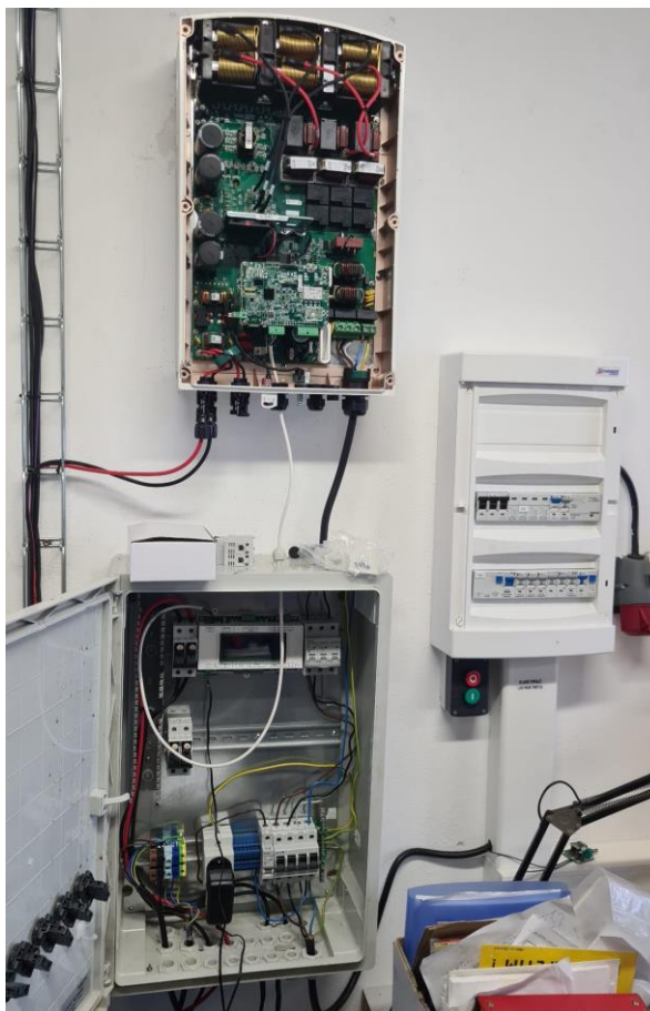
Obrázek 27 – detail vnitřních komponent elektrárny na střeše hal ČVUT
