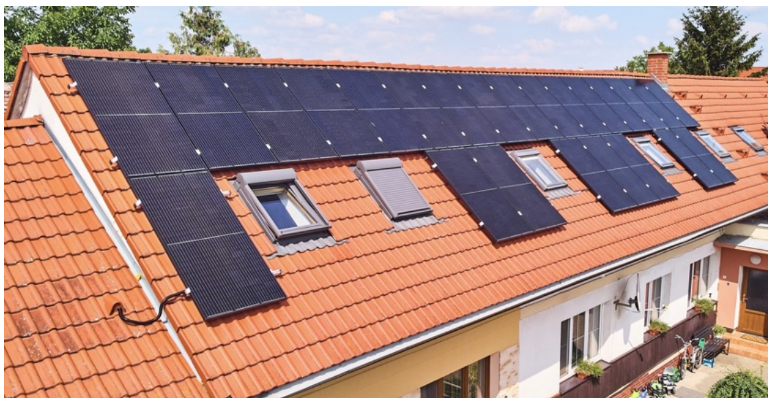
Obr. 2-2: FVE na střeše rodinného domu, systém bez hromosvodu [29]
