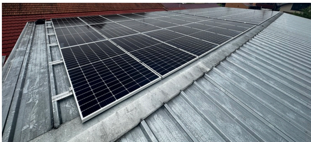
Obr. 4-12: 2. část FVE na 2. stavbě
