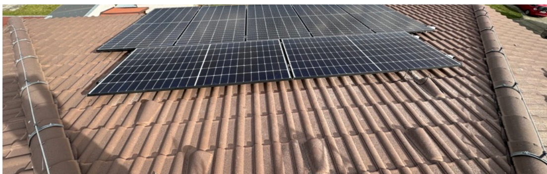
Obr. 4-15: FVE východní strana – systém spojený s hromosvodem
