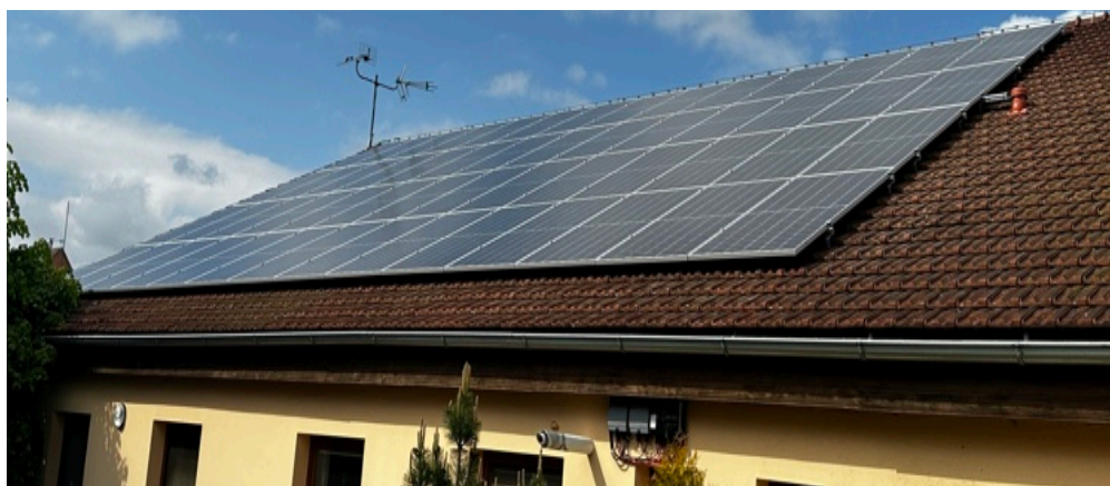
Obr. 4-11: 1. část FVE na 1. stavbě
