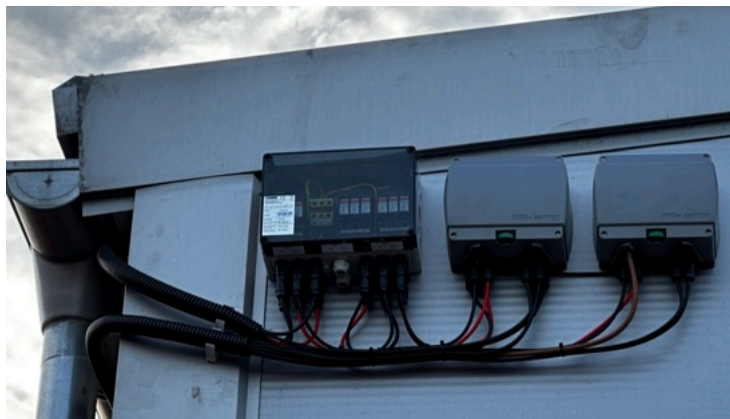
Obr. 4-9: SPD box s motorovými vypínači na rozhraní LPZ 0/LPZ 1
