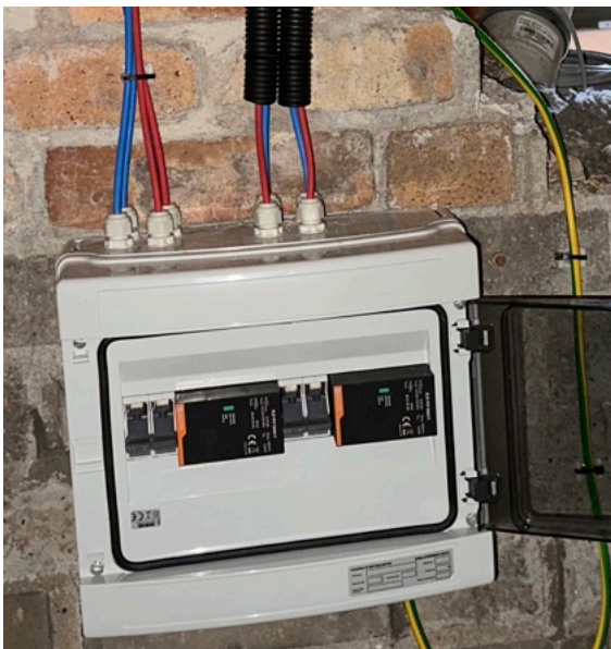
Obr. 4-17: Rozváděč fotovoltaiky RFVE
