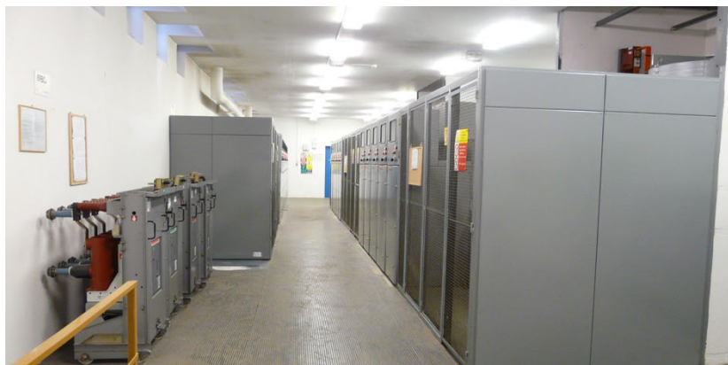
Obr. 49- Fotografie stávající rozvodny R1 + R2 + R10
