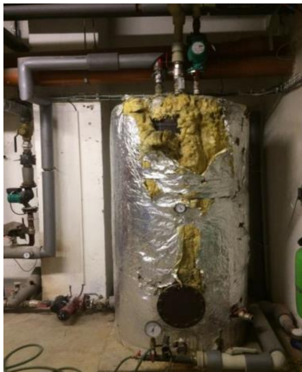
Obr 5: Degradující tepelná izolace na zásobníku tepla v bytovém domě v Praze, Zdroj: fotoarchiv společnosti ADITEX, spol. s r.o.
