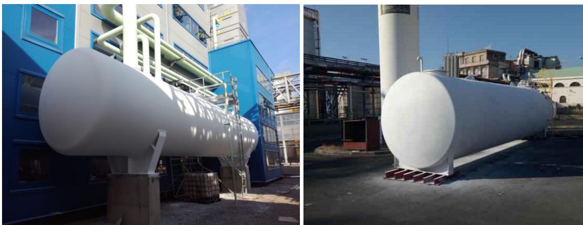
Obr 57: Chemoprojekt, a.s., vlevo venkovní nádrž na chladicí vodu, vpravo venkovní nádrž na glycerin, Zdroj: ADITEX, spol. s r.o.
