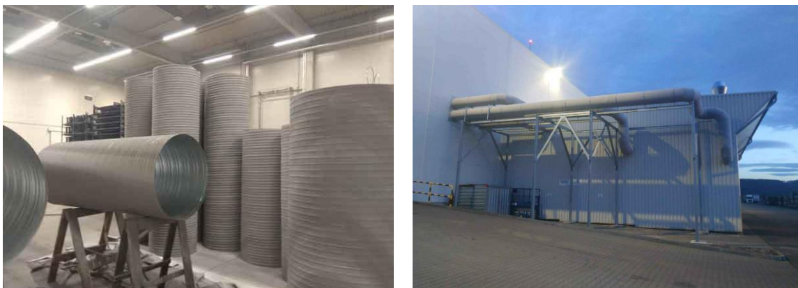
Obr 60: Lear Corporation, Vzduchotechnické potrubí opatření termoizolačním nástřikem v šedé barvě, vlevo připravené jednotlivé díly potrubí s již aplikovanou termoizolační hmotou, vpravo potrubí již nainstalované, Zdroj: ADITEX, spol. s r.o.
