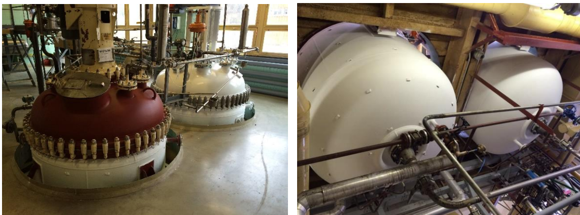
Obr 54: Krystalizační kotle společnosti VUAB Pharma a.s., vlevo červenohnědá část kotle před aplikací termoizolačního nátěru a vpravo kotle již po aplikaci, Zdroj: ADITEX, spol. s r.o.
