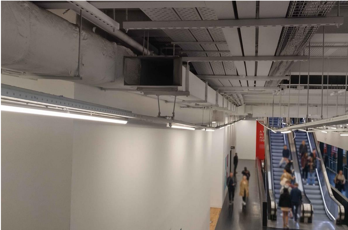
Obr 19: interiér budovy Tate modern – technické rozvody pod stropem ve světlé variantě, Zdroj: fotoarchiv autora
