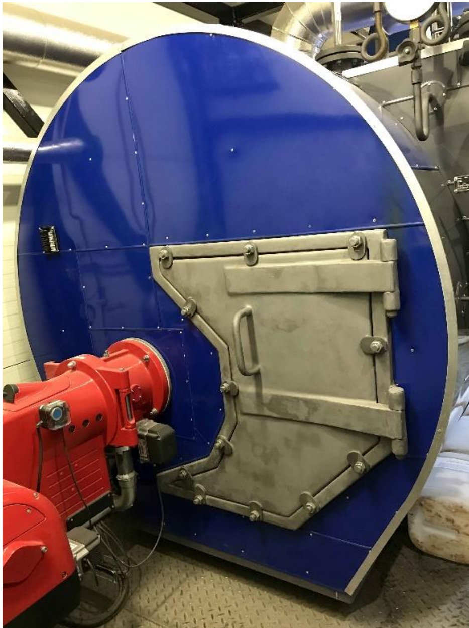
Obr 45: Čelní strana parního kotle v kontejnerové kotelně v Milovicích s pohledem na řešená vrata, Zdroj: fotoarchiv autora
