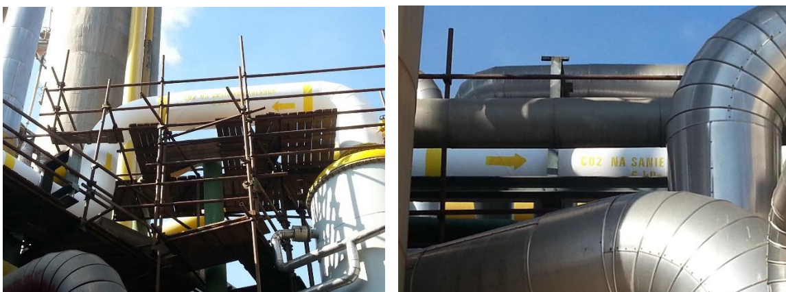
Obr 58: DUSLO, a.s., venkovní potrubí s médiem CO 2 , Zdroj: ADITEX, spol. s r.o.
