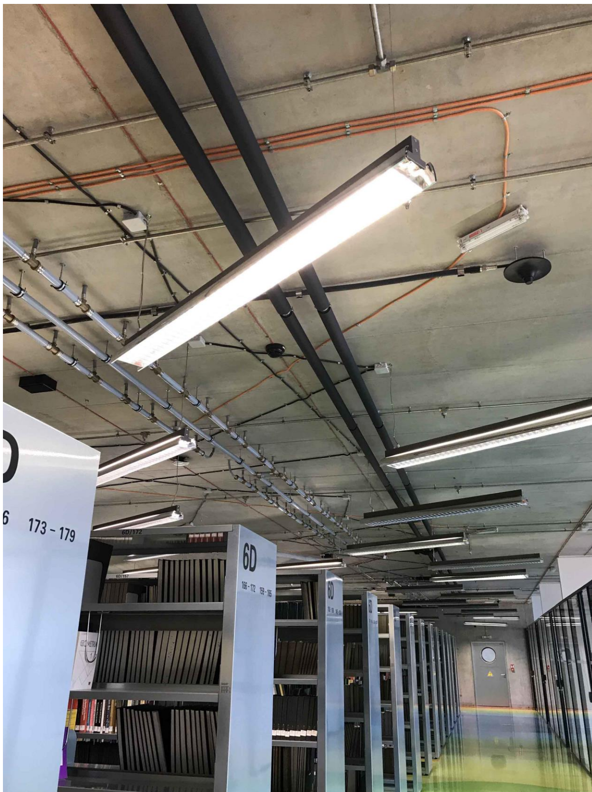
Obr 22.: Národní technická knihovna v Praze – technické rozvody pod stropem, Zdroj: fotoarchiv autora
