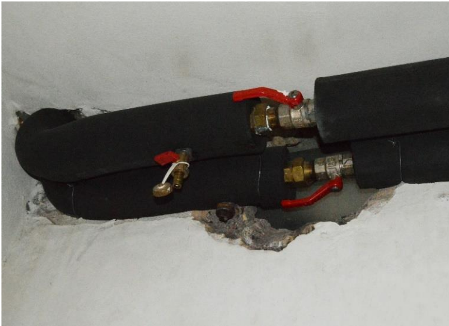
Obr 4: Nedostatečný prostor pro dodatečnou tepelnou izolaci potrubí při rekonstrukci technických rozvodů „vyřešen“ destrukcí stavební konstrukce, bytový dům Praha, Zdroj: fotoarchiv autora
