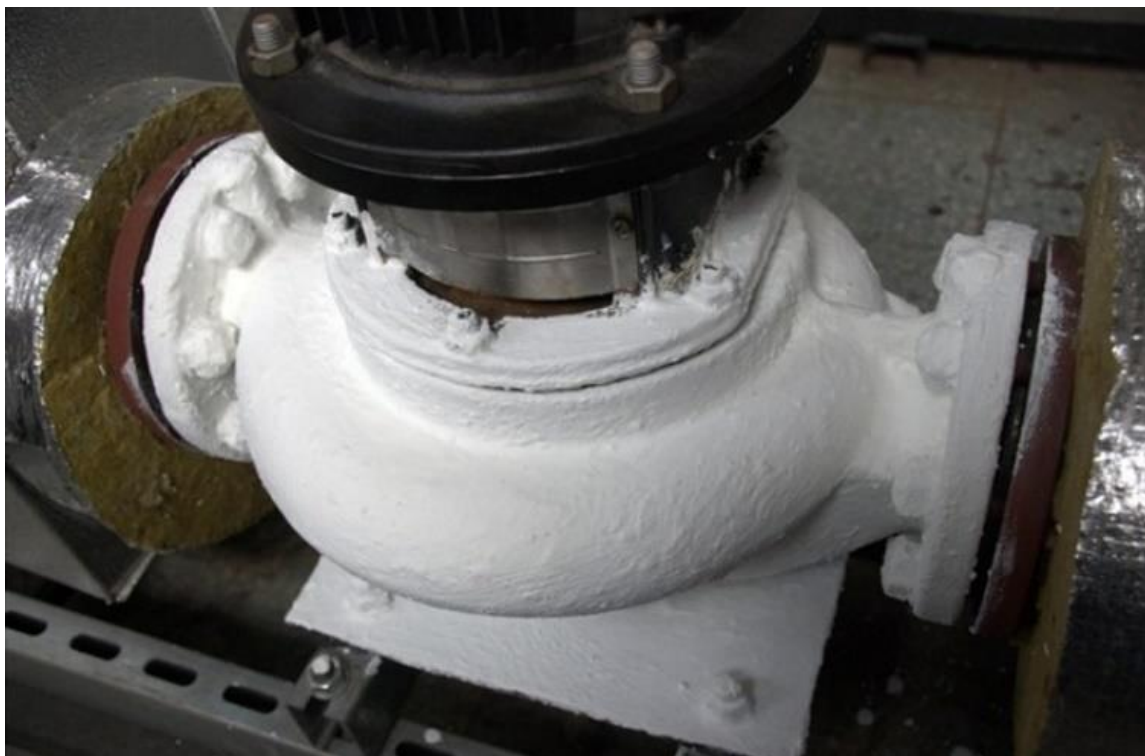
Obr 2: Ventil v teplárně v Hlučíně s aplikovanou vrstvou termoizolační nátěrové hmoty, Zdroj: fotoarchiv společnosti ADITEX, spol. s r.o.
