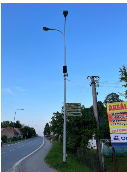
Obrázek 47 LED lampa č. 6 v obci Bernartice. [31]
