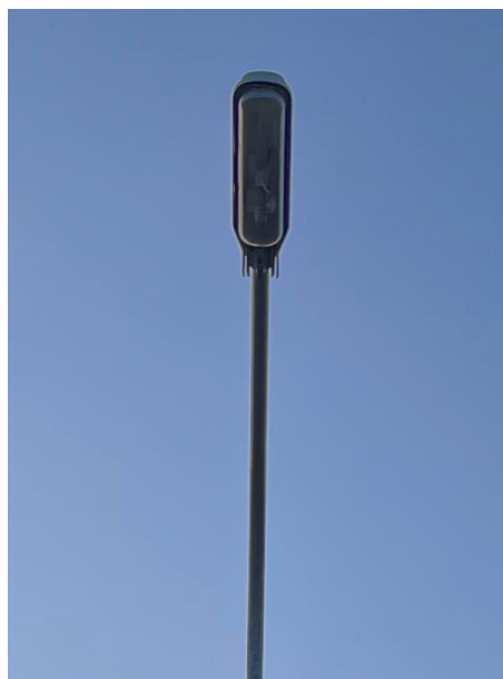
Obrázek 49 Detail svítidla č. 7 v obci Bernartice. [31]
