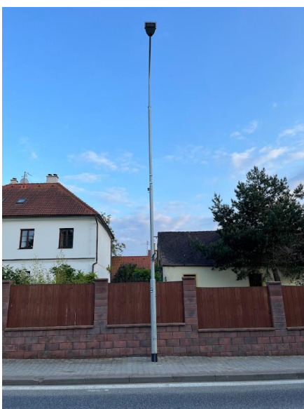
Obrázek 45 LED lampa č. 1 v obci Bernartice. [31]
