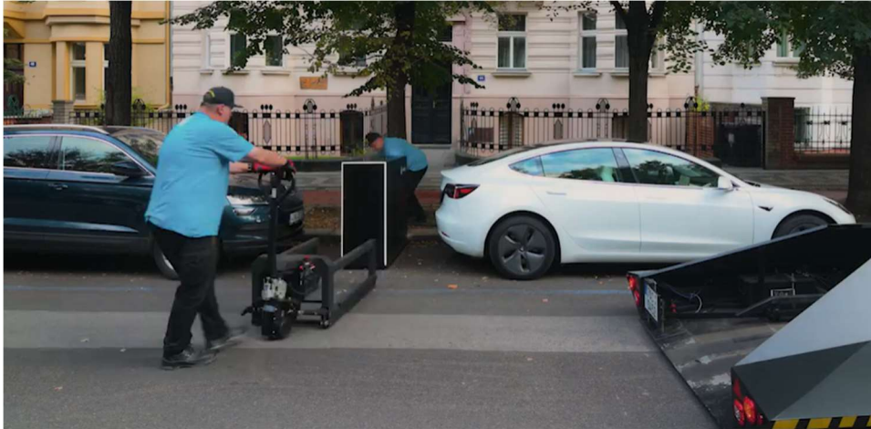
Obrázek 7 Nabíjecí stanice Nimbee při nasazování do provozu [19]
