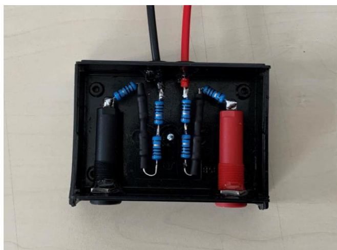
Obrázek 4.20: Bezpečnostní rezistory 5 \times 20 \Omega , dva rezistory na každé větvi jsou přelepeny izolační páskou
