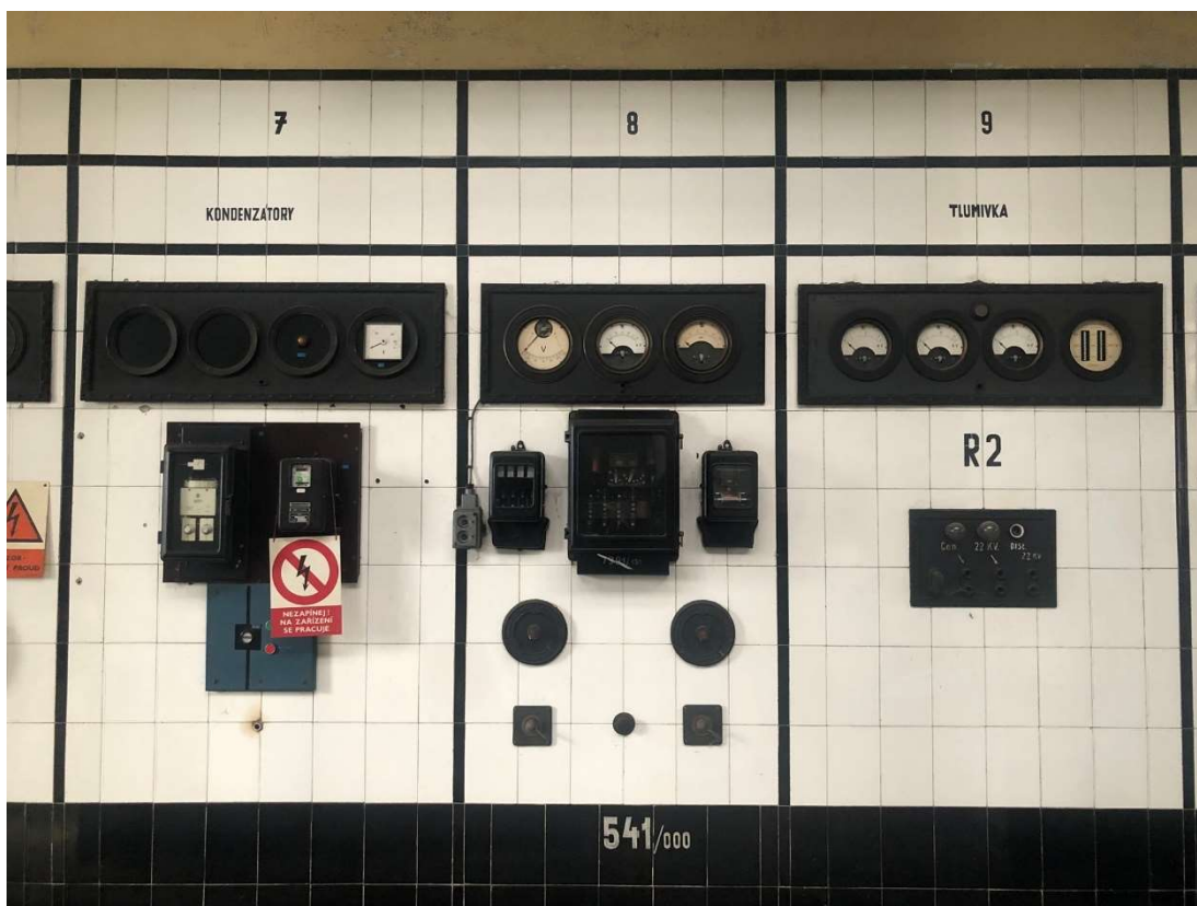
Obr. 98 – Centrála, detail stěny s řídicími panely s litinovými rámy, 2022, Zdroj: archiv autora
