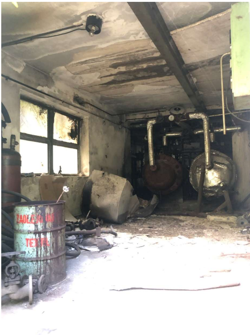
Obr. 221 – Olejová stanice, interiér, 2021, Zdroj: archiv autora
