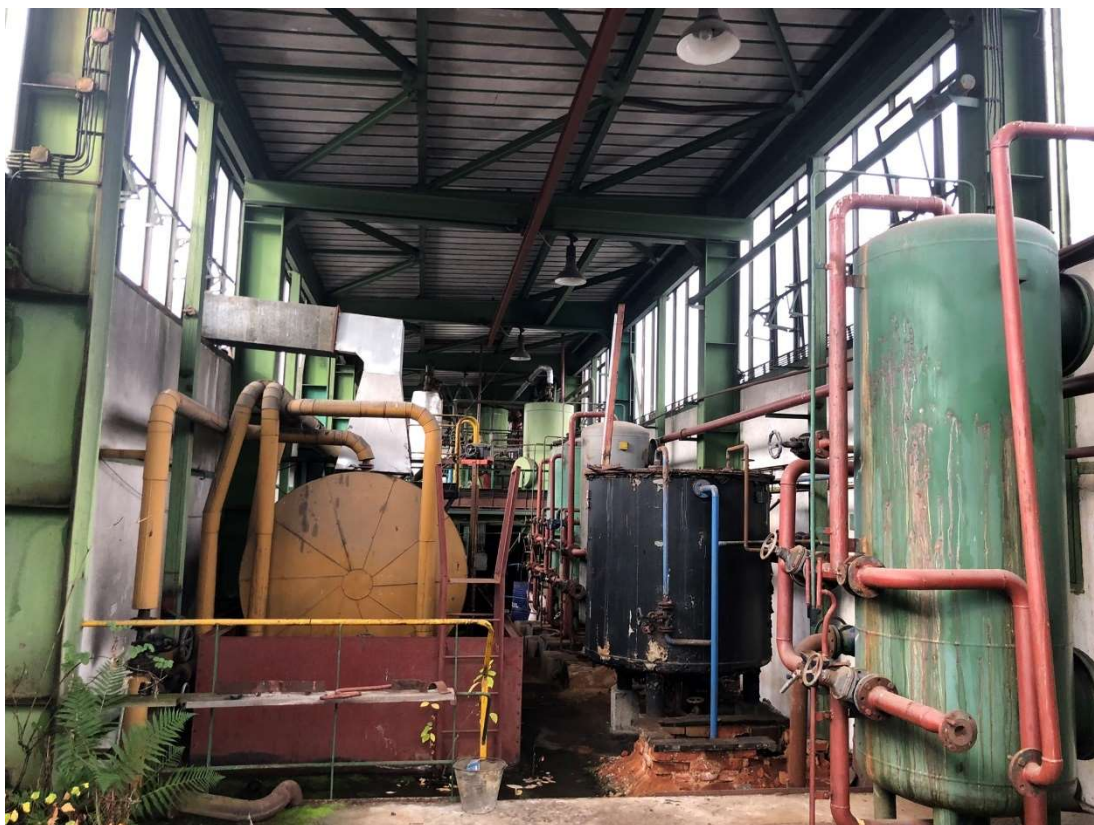
Obr. 253 – Kotelna, interiér – technologické zařízení kotelny, 2022, Zdroj: archiv autora
