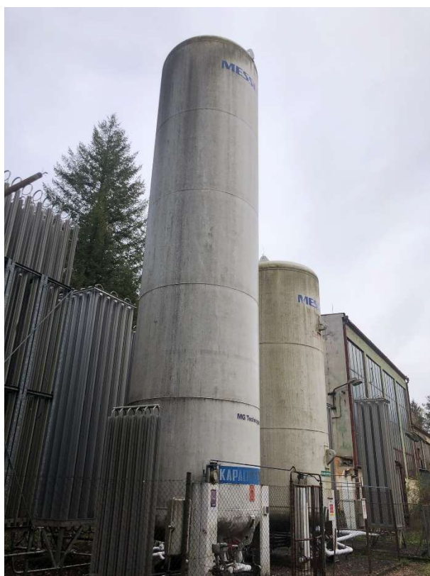
Obr. 170 – Nádrže na kyslík, nahrazující původní technologii v budově kyslíkárny, 2022. Zdroj: archiv autora
