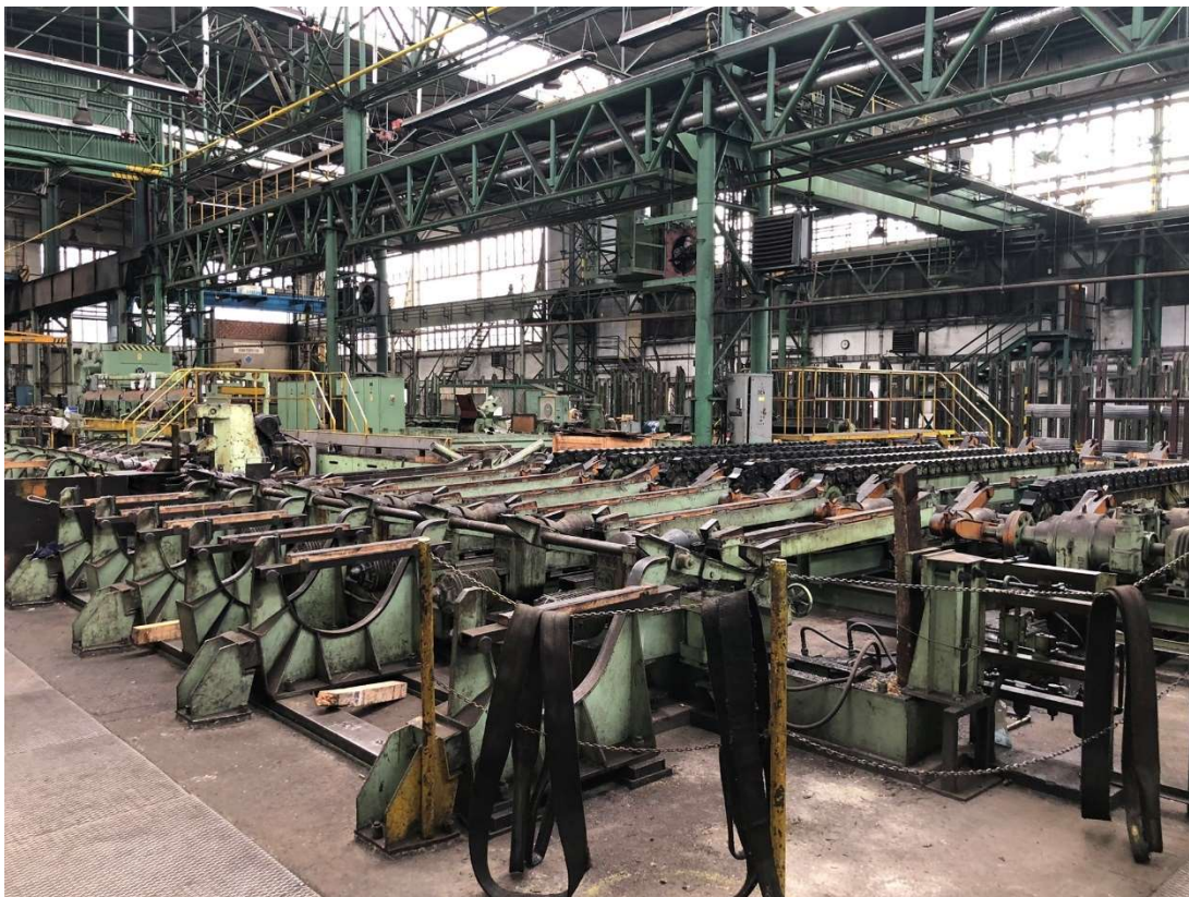
Obr. 195 – Loupárna, interiér s technologickým zařízením, 2022, Zdroj: archiv autora
