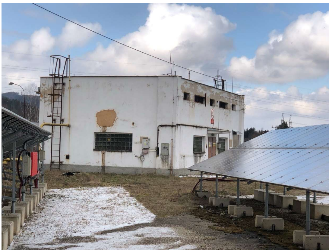
Obr. 296 – Regulační stanice plynu, pohled severovýchodní, 2021, Zdroj: archiv autora
