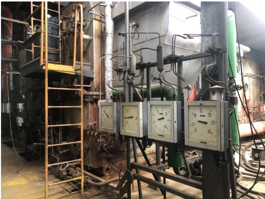
Obr. 251 – Kotelna, interiér, 2021, Zdroj: archiv autora
