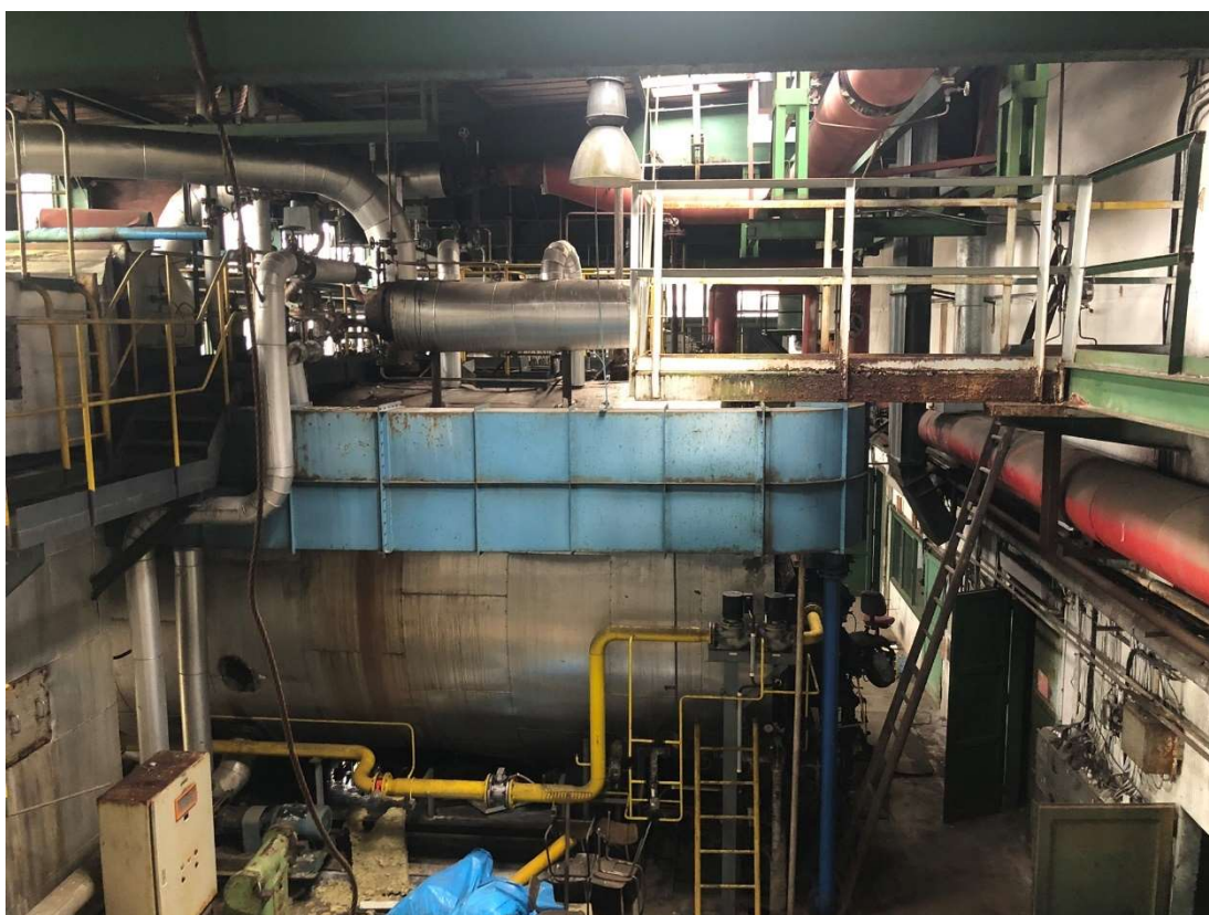
Obr. 254 – Kotelna, interiér – technologické zařízení kotelny, 2022, Zdroj: archiv autora
