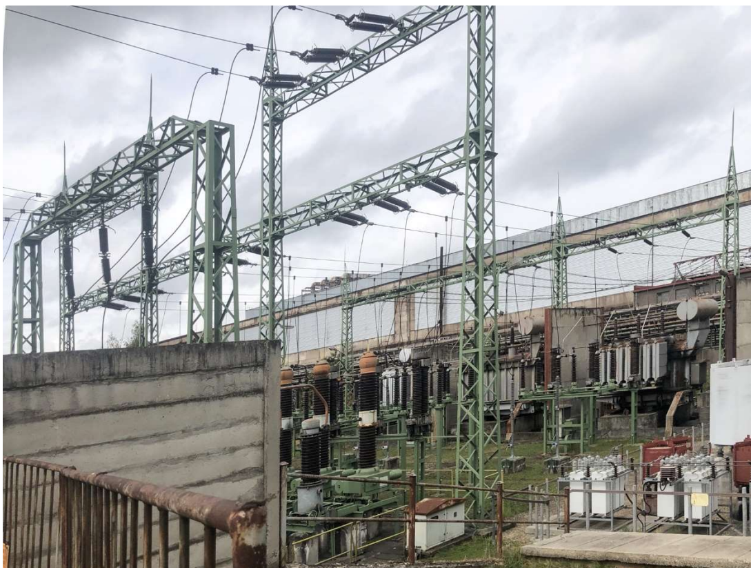
Obr. 174 – Venkovní rozvodna 110kV, 2021, Zdroj: archiv autora
