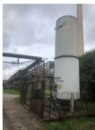
Obr. 289 – Odpařovací stanice na argon, 2021, Zdroj: archiv autora
