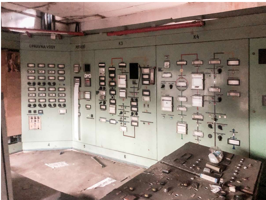
Obr. 252 – Kotelna, interiér, 2021, Zdroj: archiv autora
