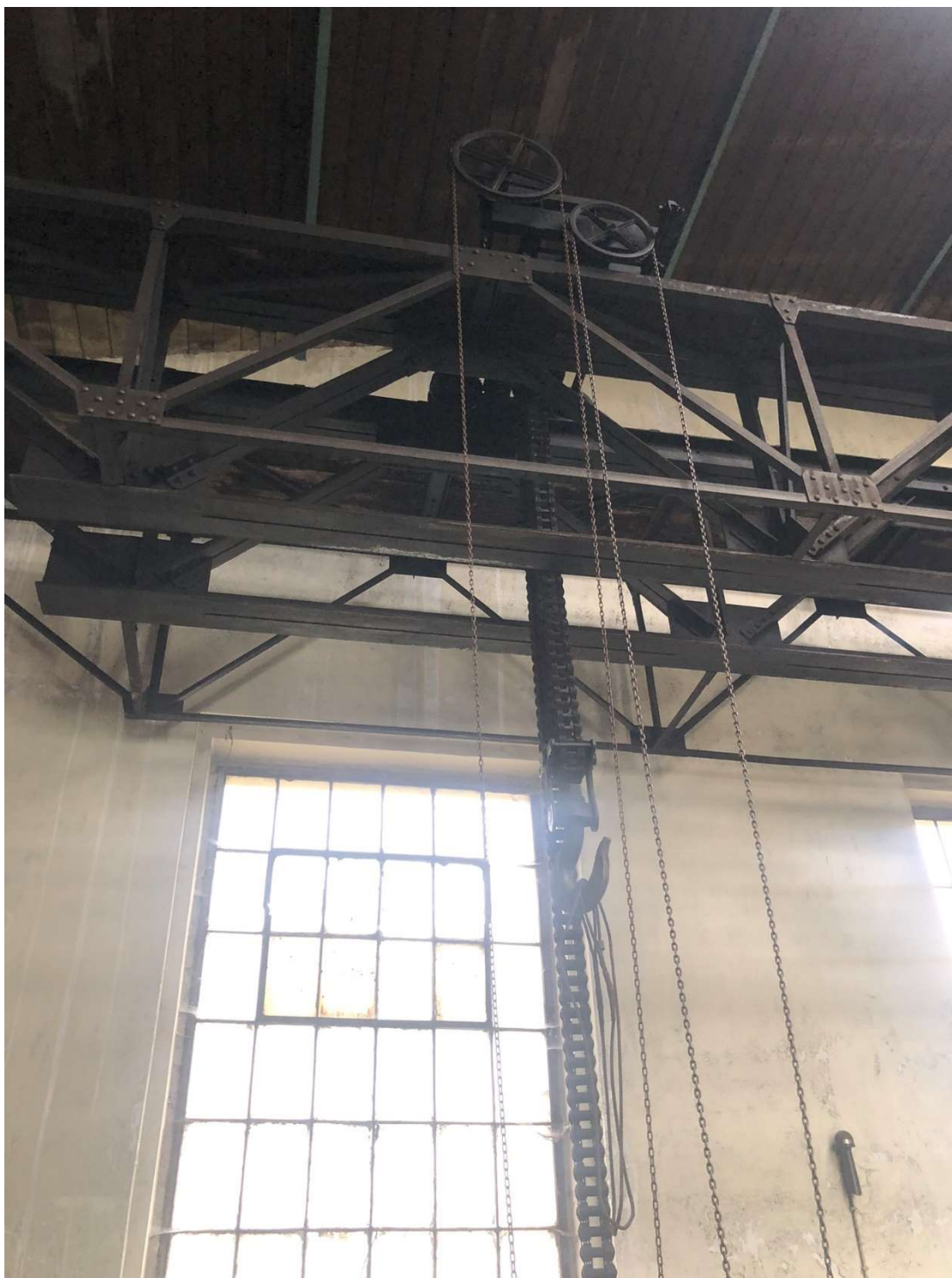
Obr. 99— Centrála, detail funkční jeřábové dráhy s řetězovým ručním ovládním, 2022, Zdroj: archiv autora
