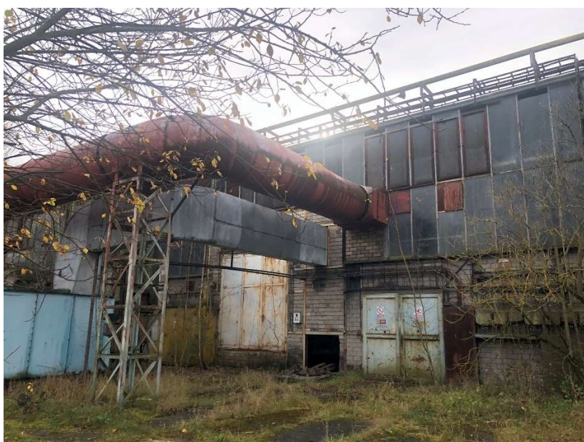
Obr. 250 – Kotelna, detail na rozvodné potrubí z kotelny, 2021, Zdroj: archiv autora
