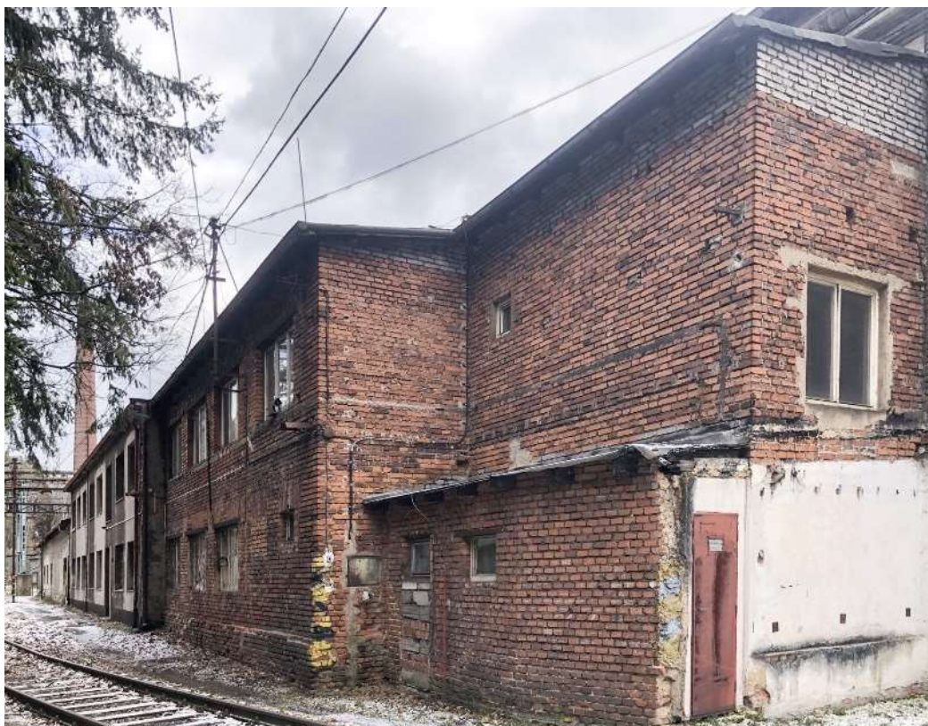
Obr. 230 – Přístavba budovy hygienického zařízení z roku 1967, na severní straně úpravny hrubé válcovny, 2021, Zdroj: archiv autora
